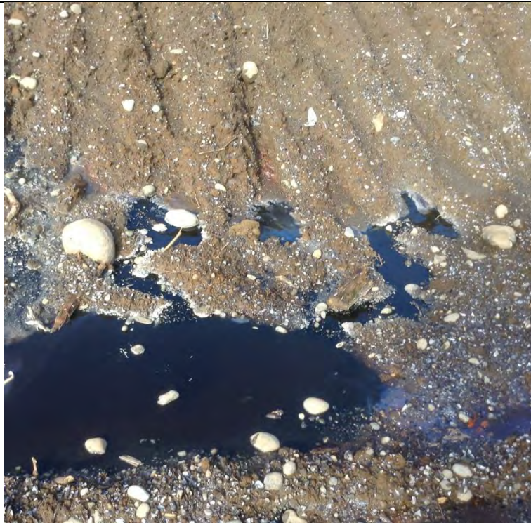
Imagen N° 44: Lixiviado aposado en la base de la torta en el sector Sur Oeste del Vertedero Dicham
