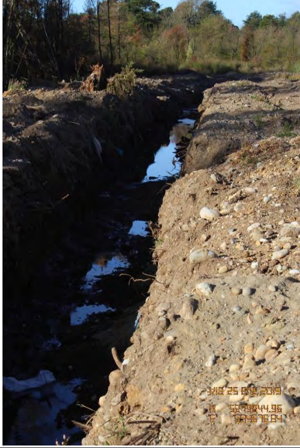
Imagen N° 29: Sección de canal perimetral con agua acumulada
