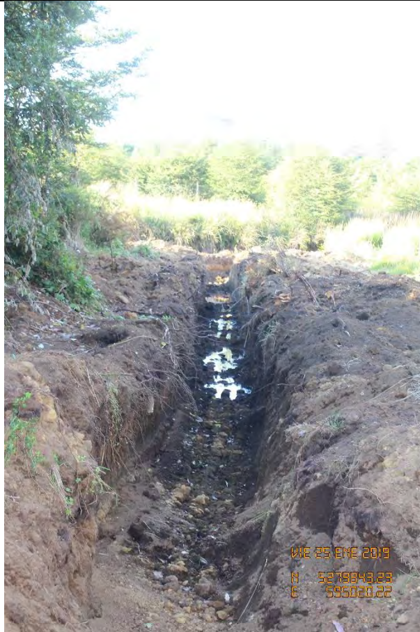
Imagen N° 31: Sección de canal perimetral que no cumple con dimensiones autorizadas
