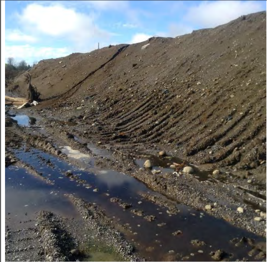
Imagen N° 49: Lixiviado aposado en el sector Sur Oeste, en la base de la torta de residuos
