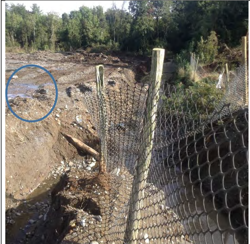
Imagen N° 50: Presencia de aposamiento de lixiviados al borde de la zanja perimetral de aguas lluvias
