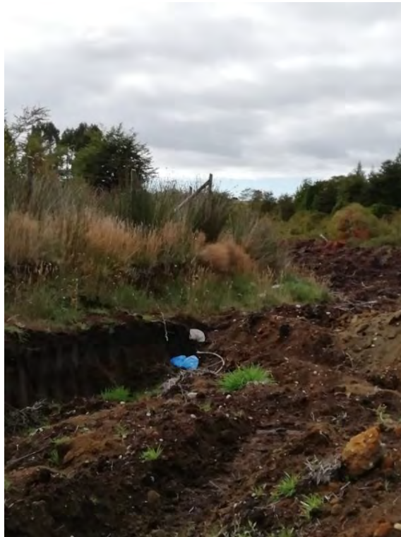
Imagen N° 33: Canal perimetral sector oeste, se encuentra incompleto
