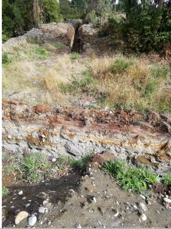
Imagen N° 32: Canal perimetral sector oeste, se encuentra incompleto
