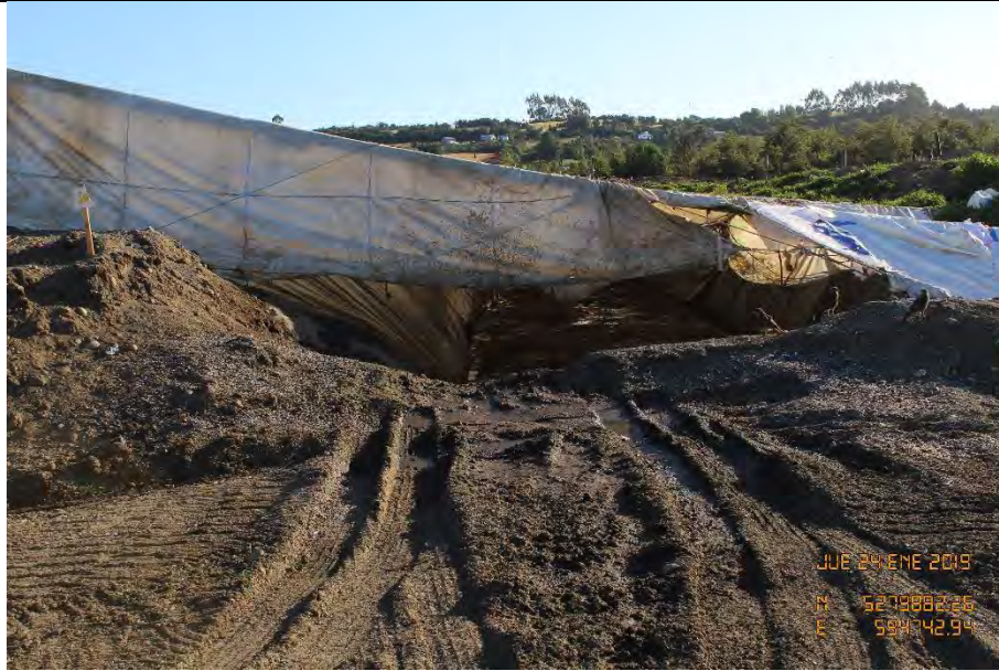
Imagen N° 27: Zanja N° 34 con lodos industriales
