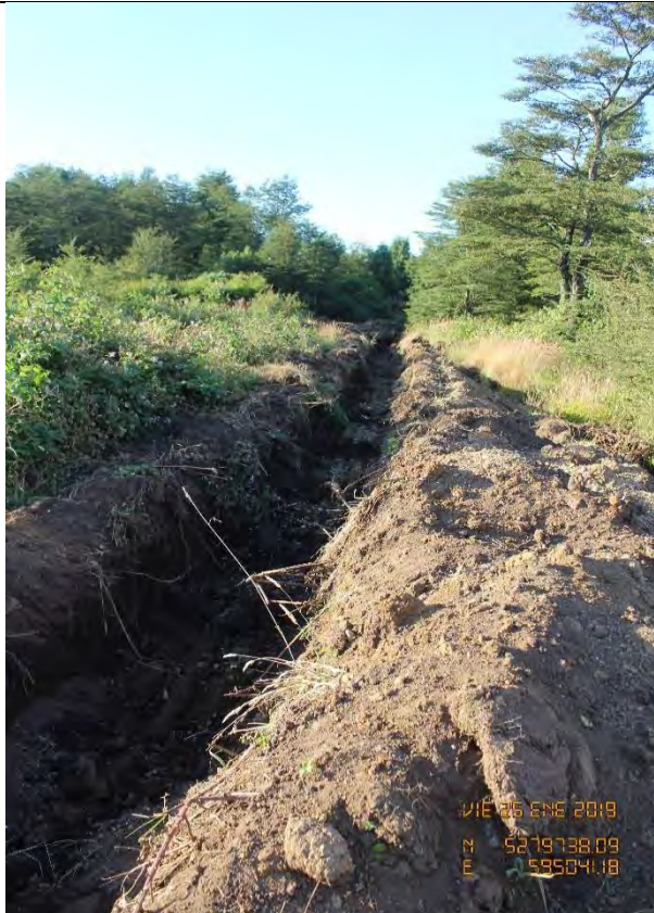
Imagen N° 30: Sección de canal perimetral que no cumple con dimensiones autorizadas
