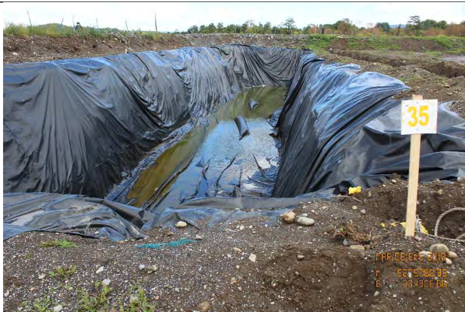
Imagen N° 28: Zanja N° 34 con lodos industriales
