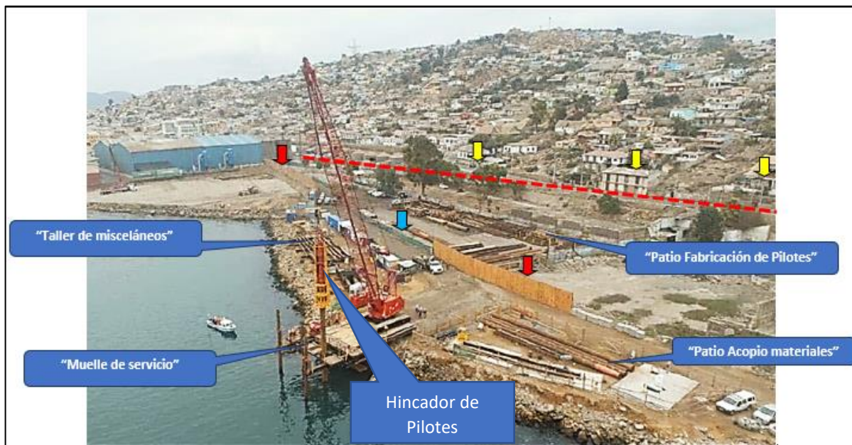
Foto 1: Vista desde el mar hacia el sector de construcción del proyecto. Se indica la localización de los receptores de ruido (flechas amarillas), Barreras Acústicas fijas (flechas rojas) y Cierro con malla (Flecha celeste) (Fuente imagen: titular del proyecto)
