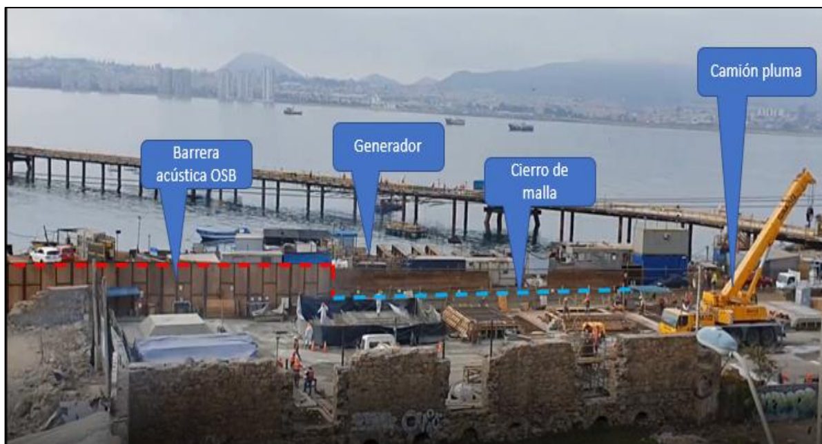
Foto 2: Vista desde casa de receptor de ruidos D2 hacia sector "Patio de Fabricación de Pilotes" con actividades de construcción del proyecto. Se indica la localización de Barrera Acústica Fija (línea punteada roja) y Cierro de Malla (línea punteada celeste) (Fuente: captura de imagen de video presentado en denuncia http://siden.sma.gob.cl/Denuncia/Ficha/26731 )
