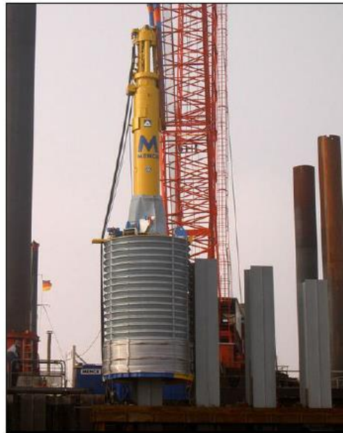
Ilustración 3-16: Fotografía encierro acústico en Martinete.
