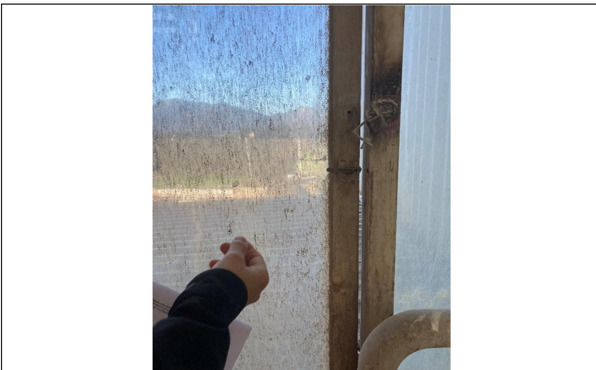
Fotografía N° 5 Fecha: 7-07-2022 Coordenadas UTM DATUM WGS84 HUSO 19 Norte: 6305529 Este: 285726 Descripción del medio de prueba: Sector e entre pisos con presencia de sectores con vidrio simple y ventanas, también con vidrio simple, con macilla desgastada y semiabierta.
