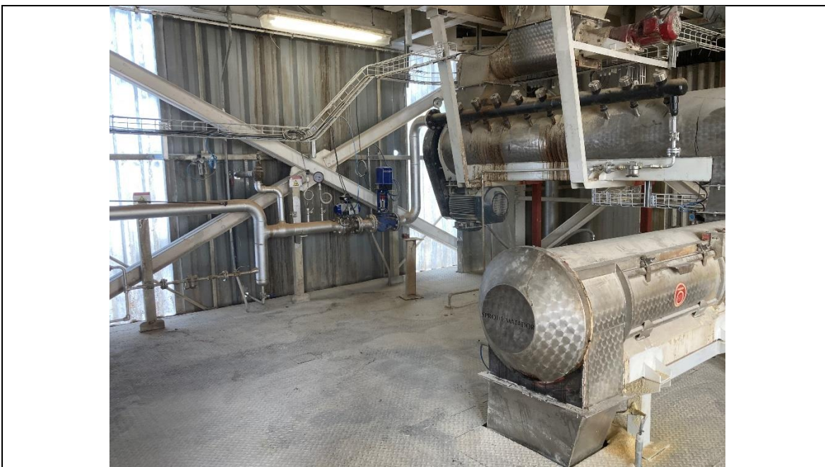
Fotografía N°3 Fecha: 7-07-2022 Coordenadas UTM DATUM WGS84 HUSO 19 Norte: 6305529 Este: 285726 Descripción del medio de prueba: Prensas para compresión de pasta (alimento). Equipamiento en nivel 3, que genera ruido.
