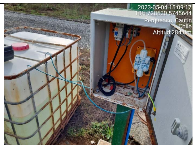
Fotografía 4. Inexistencia de equipo dosificador de cloro en sistema de desinfección de efluente de PTAS Perquenco.
