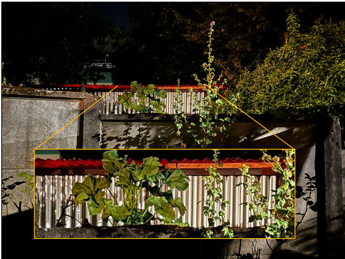
Figura N°1: Registro fotográfico de fecha 03 de febrero de 2024, donde se observan aberturas en infraestructura de la UF "Discooteca Tokio".
