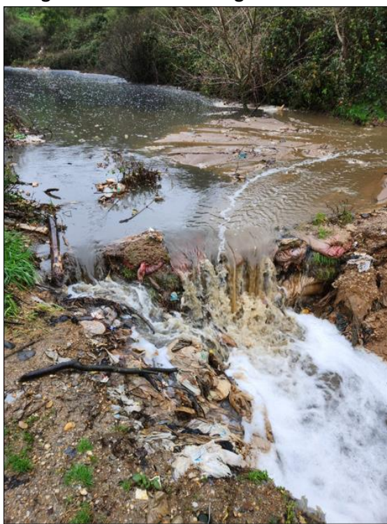
Imagen N° 3. Rebalse de laguna de lixiviados
