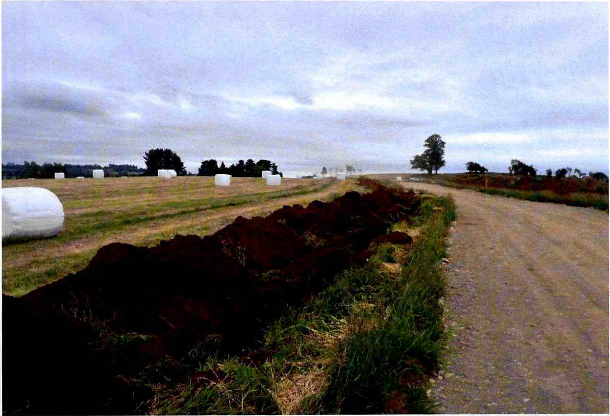
Fotografía 2. Trazado subterráneo del sistema de abastecimiento de agua del proyecto “Loteo Alto Maullín” (24-12-2020).
