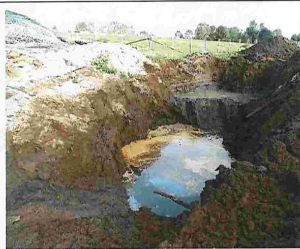
Fotografía N°9: Se observa dos pozos sin impermeabilizar, para la acumulación de líquidos provenientes de la zona de recepción y armado de redes.
