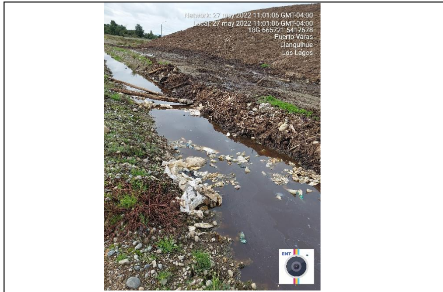
Fotografía N°5: cuneta del lado norte del alveolo 1 se constata agua lluvia mezclado con lixiviados y residuos.
