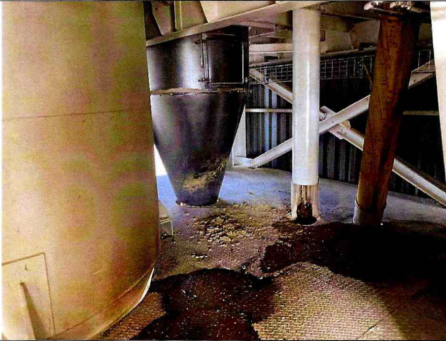
Fotografía N°7 Fecha: 7-07-2022 Coordenadas UTM DATUM WGS84 HUSO 19 Norte: 6305529 Este: 285726 Descripción del medio de prueba: Continuidad de ciclones en el nivel 7, con presencia de polvillo (material particulado) en suelo e infraestructura.
