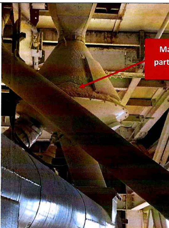
Fotografía N°10 Fecha: 7-07-2022 Coordenadas UTM DATUM WGS84 HUSO 19 Norte: 6305529 Este: 285726 Descripción del medio de prueba: Material particulado o polvillo generado del proceso productivo en instalaciones de la torre.
