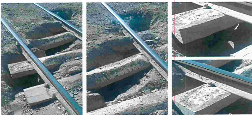
Imagen N°3. Socavones en vía férrea de FCAB
