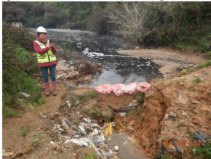
Imagen N°2: Desmoronamiento de pretil de laguna de lixiviados
