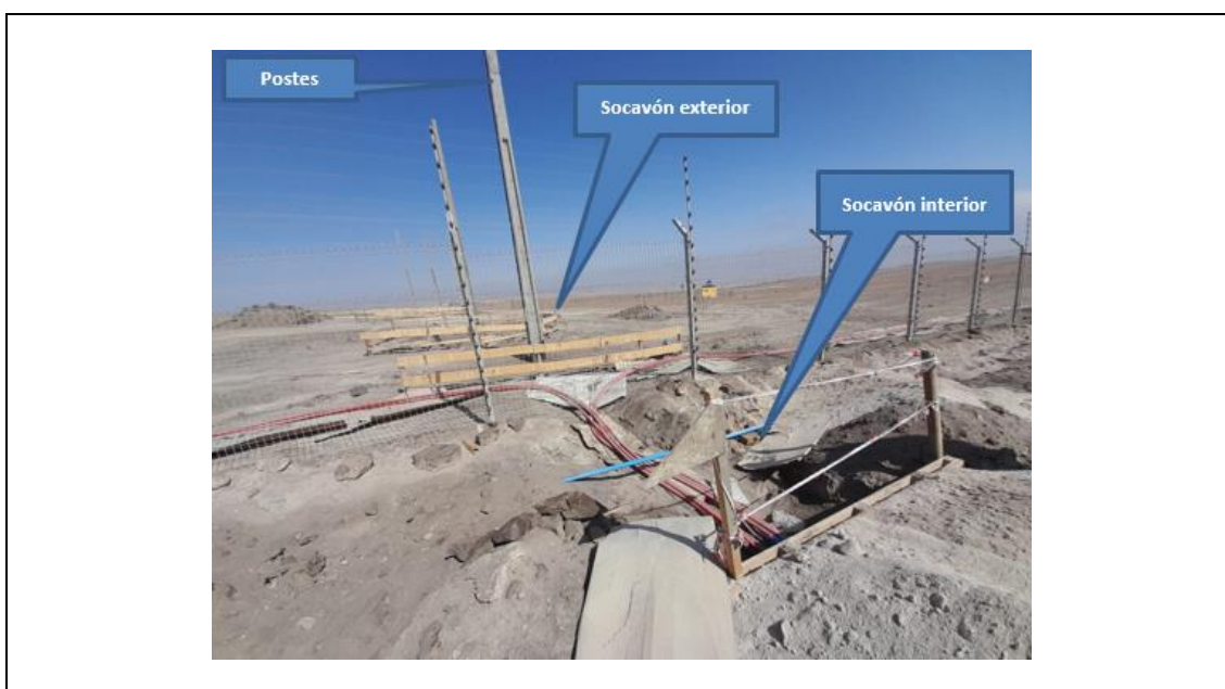
Fuente: imagen tomada por fiscalizadores de la SMA en terreno.
