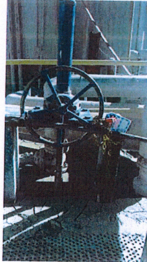
Figura 1: Detalle de bloqueo de lamaducto de 18 pulgadas bypass cada línea
