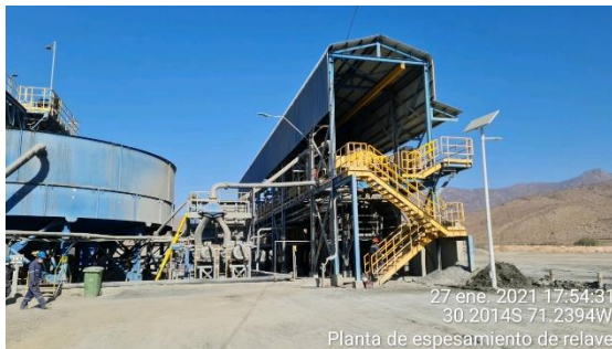
Planta de espesamiento de filtrado
