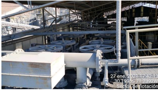
Celdas de flotación
