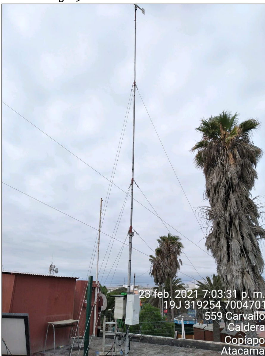
Imagen 3. Estación de Calidad del Aire
