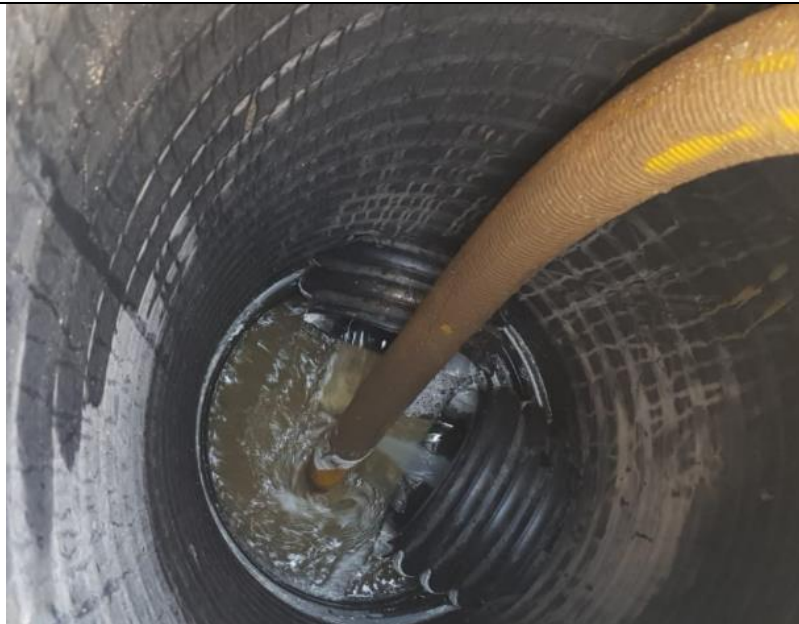
Fotografía N°2: Retiro de Lixiviados de cámaras de inspección de sobrecelda- Adecuación Zanja Sanitaria N°1, por Empresa Aconser. Tomada: Sábado 03 de Julio del 2021.
