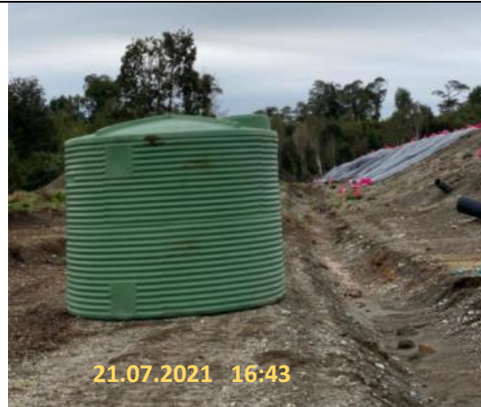
Fotografía N°8: Nuevos Estanques de acumulación de lixiviados
