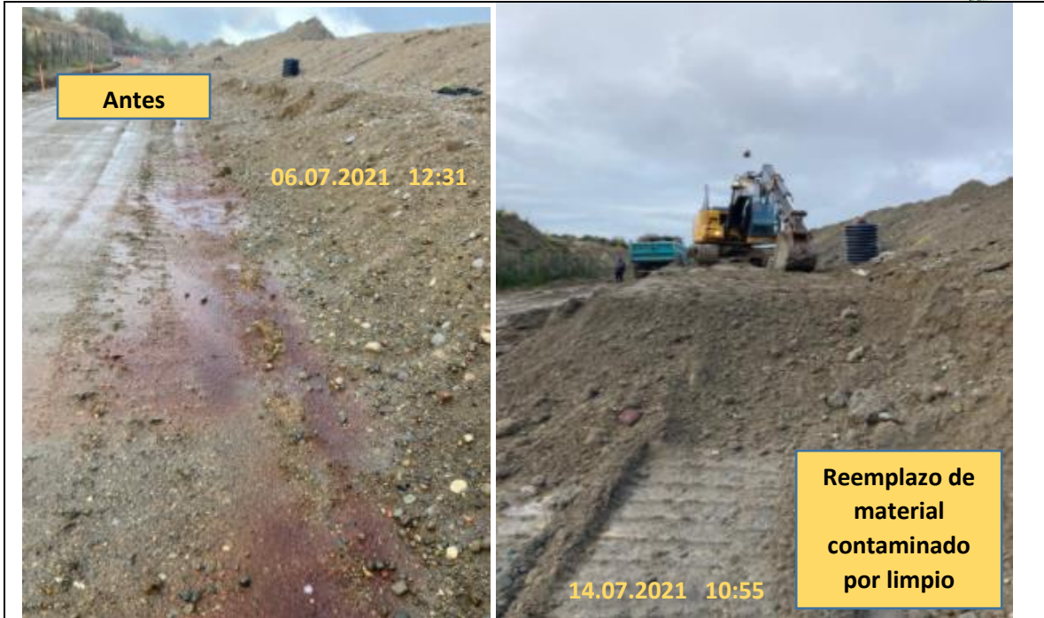
Fotografía N°14: Reemplazo todo el material del camino y del pretil de contención ubicado en la zona Este de la Zanja Sanitaria por material limpio, por Empresa Crecer.
