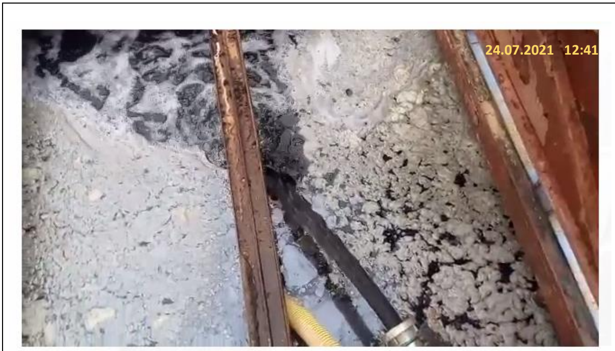
Fotografía N°7: Retiro de Lixiviados desde cámaras de inspección de sobrecelda, Zanja Sanitaria N°1 a batea de acumulación, por Empresa Crecer. Tomada: Sábado 24 de Julio del 2021.
