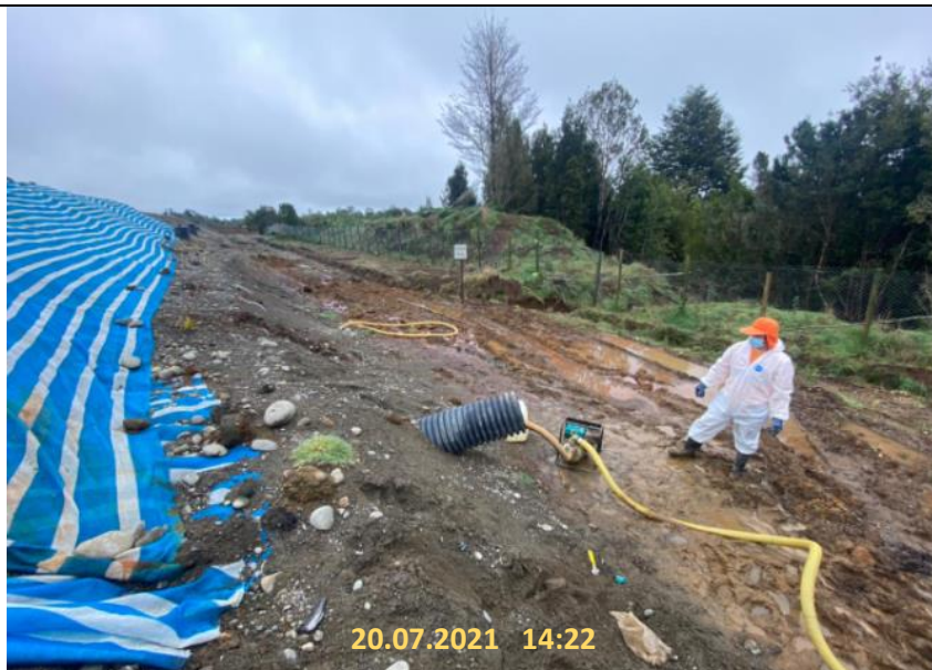
Fotografía N°3: Retiro de Lixiviados desde cámara diagonal D4 de recirculación- Zanja Sanitaria N°1, por personal de Crecer Tomada: Martes 20 de Julio del 2021.
