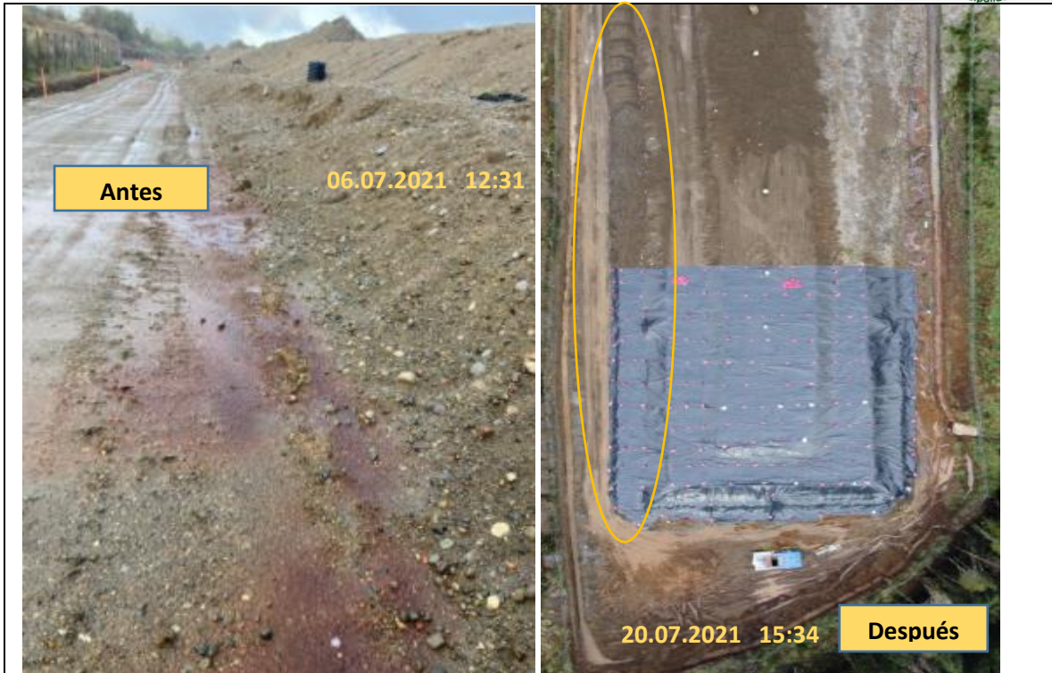
Fotografía N°12: Antes-Después Pretel de contención ubicado en la zona Este de la Zanja Sanitaria.
