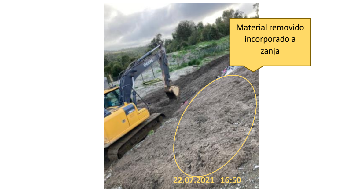
Fotografía N°17: Retiro de Material contaminado zona Oeste Zanja Sanitaria N°1 y incorporación a la zanja, por Empresa Crecer Tomada: jueves 22 de Julio del 2021.
