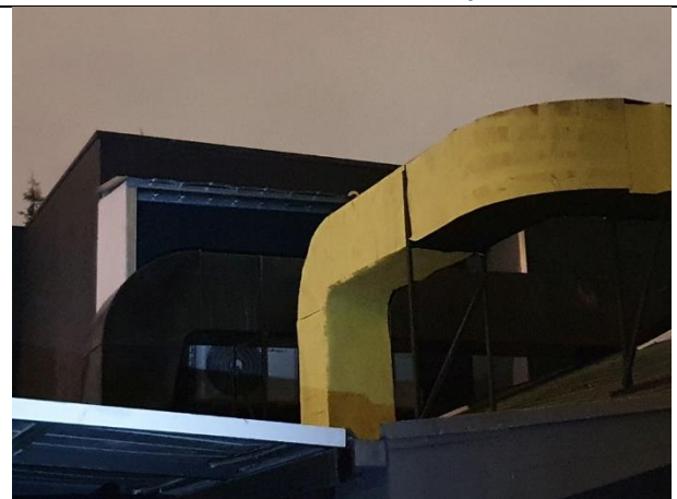
Semiencierro unidades de aire acondicionado
