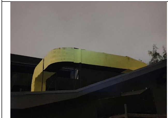
Ductos forrados con lana mineral
