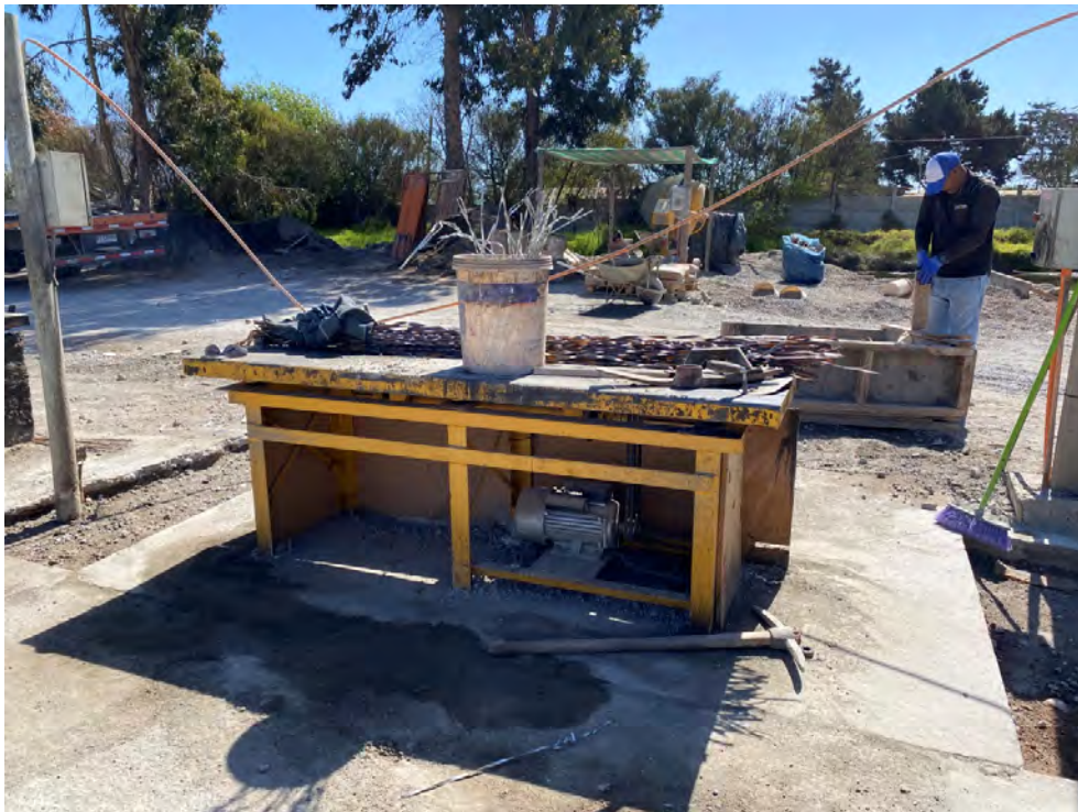
Mesa vibradora N°1
