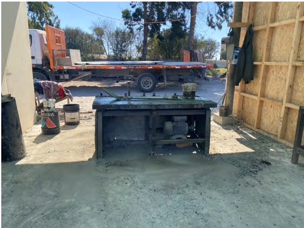
Mesa vibradora N°3
