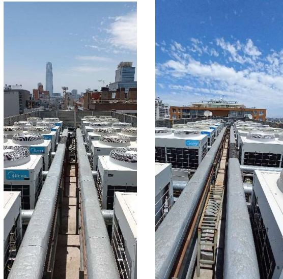
Ubicación Chiller de Climatización
