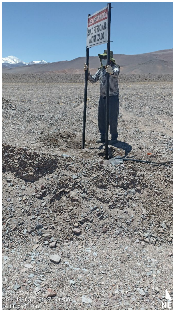
Fotografía 3: Señalética de prohibición de ingreso de personal externo al Proyecto Dorado.
