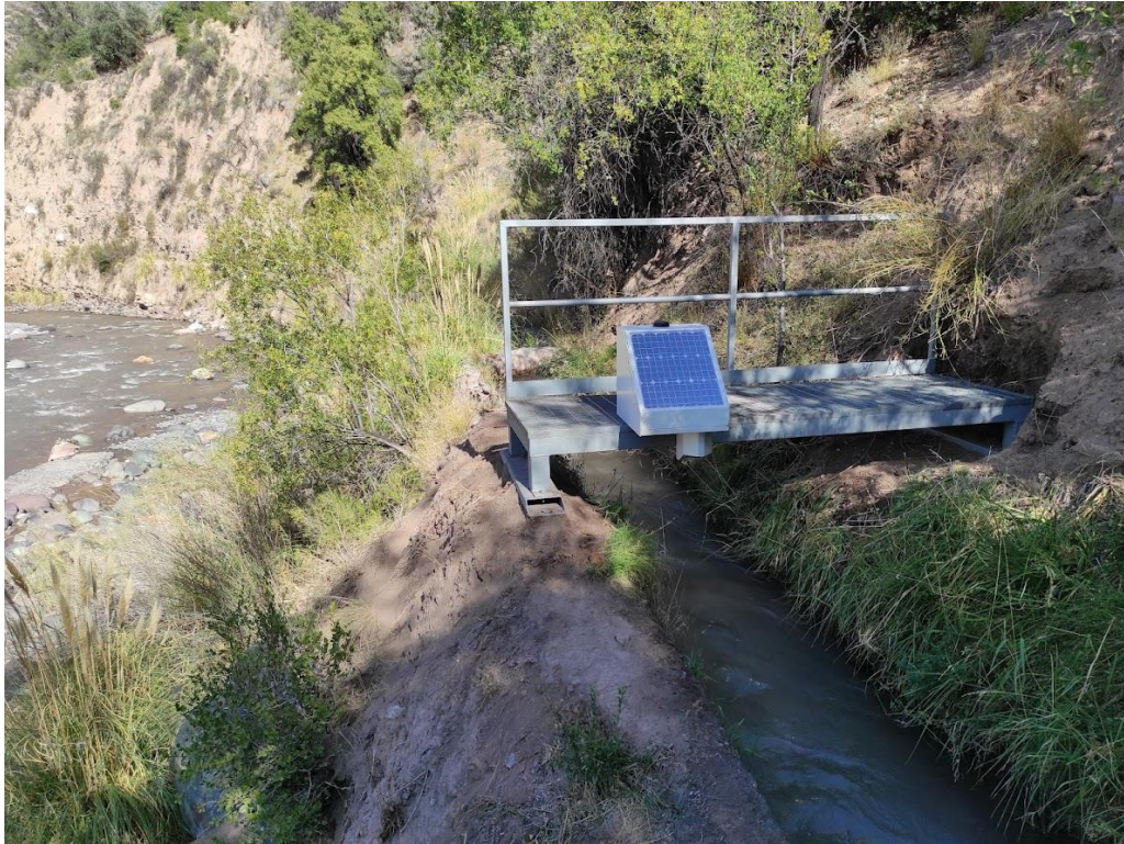
Figura 2: Instalación de CFT Radar en Canal El Manzano, vista frontal
