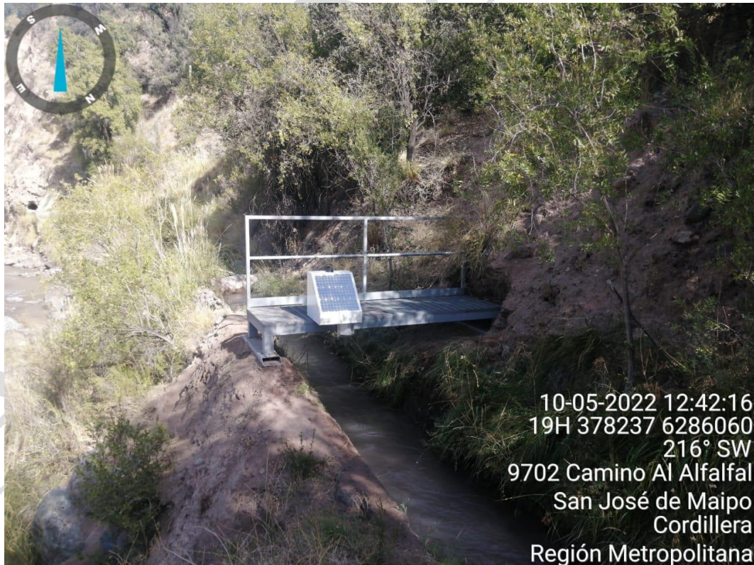
Figura 5: Instalación de CFT Radar en Canal El Manzano, imagen georreferenciada
