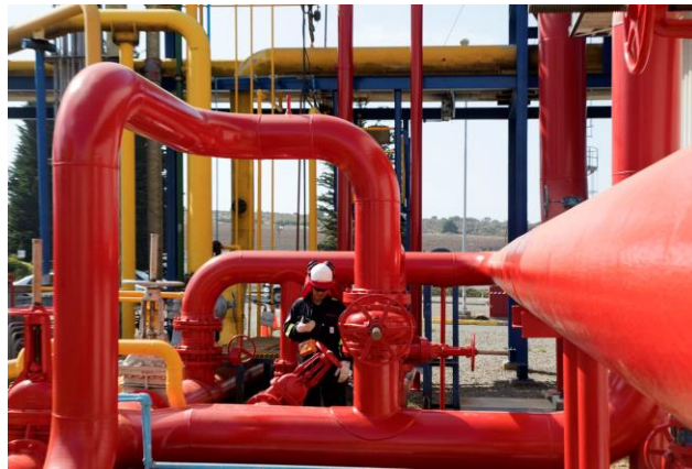
Ductos de entrega de GLP
