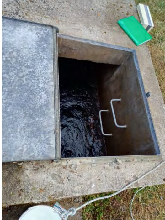
Figura 4. Estación E2 – Cámara de efluente previo a la descarga.
