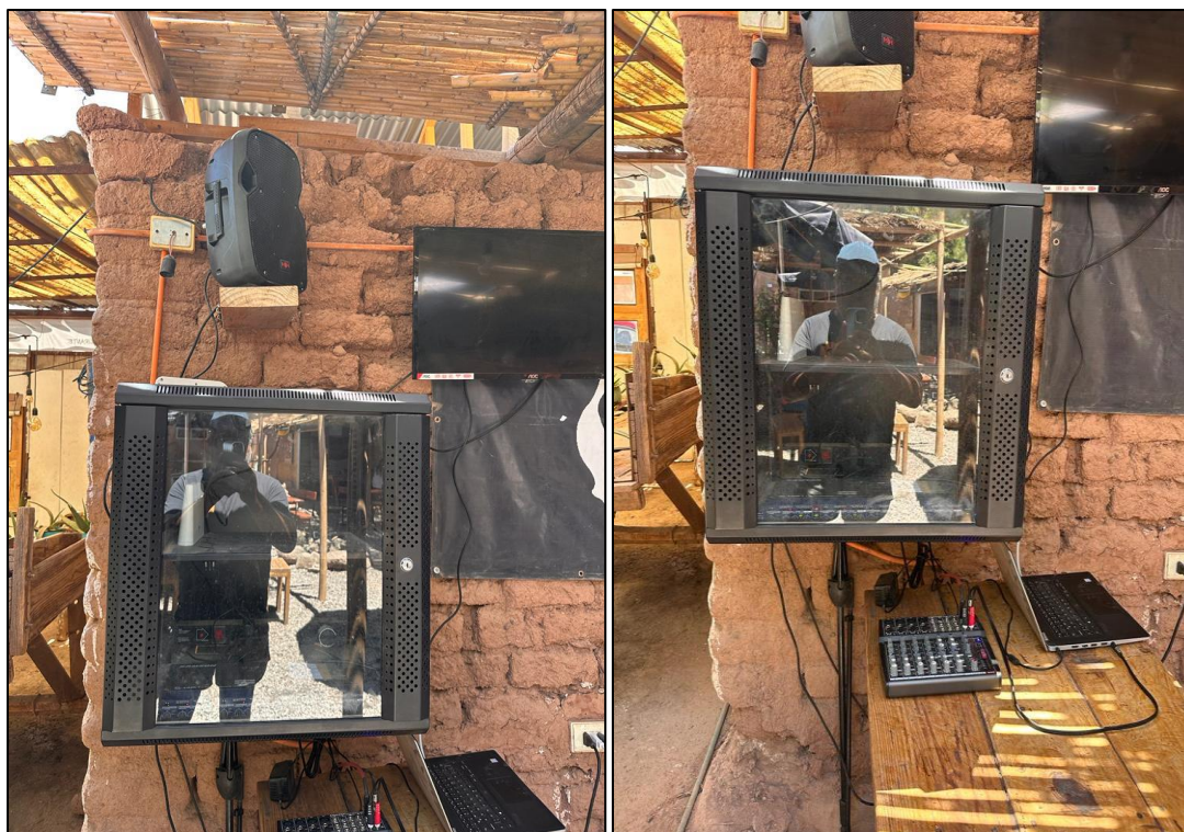
Gabinete con compresor/ limitador acústico bajo llave
