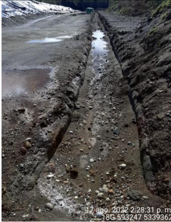
Fotografía N°46: Estado canales aguas lluvias
