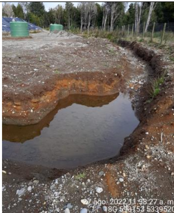
Fotografía N°55: Estado canales aguas lluvias
