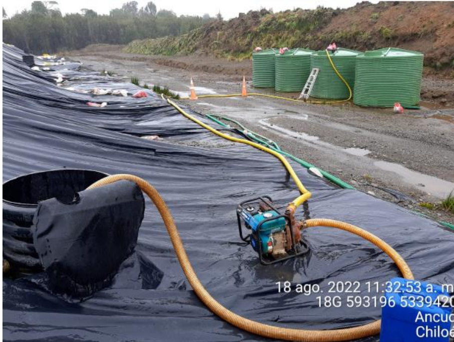
Fotografía N°10: Extracción de Lixiviados desde cámara C13 por personal municipal. Tomada: Jueves 18 de Agosto del 2022.
