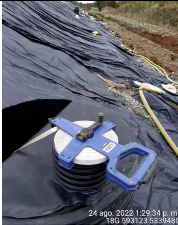
Fotografía N°41: Medición de Niveles de cámaras por Personal Municipal. Tomada: 24 de Agosto del 2022.
