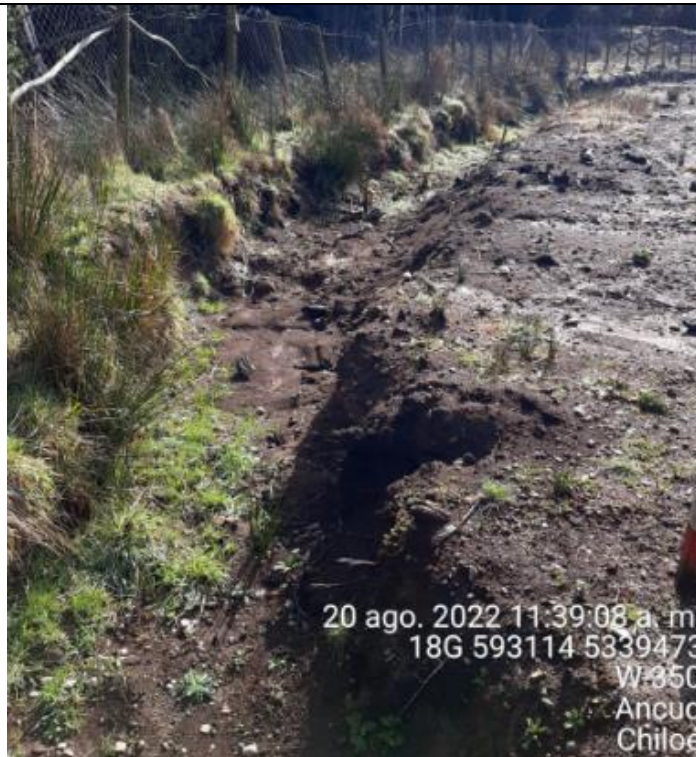
Fotografía N°49: Estado canales aguas lluvias
