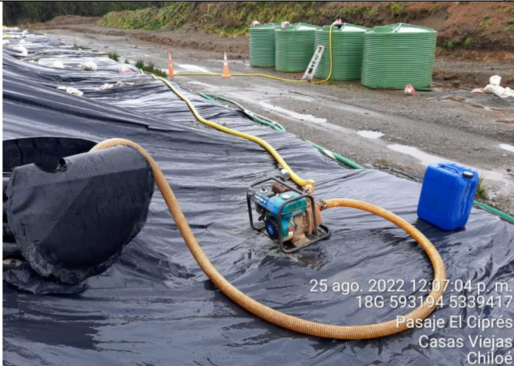
Fotografía N°26: Extracción de Lixiviados Cámara C13. Tomada: Jueves 25 de Agosto del 2022.
