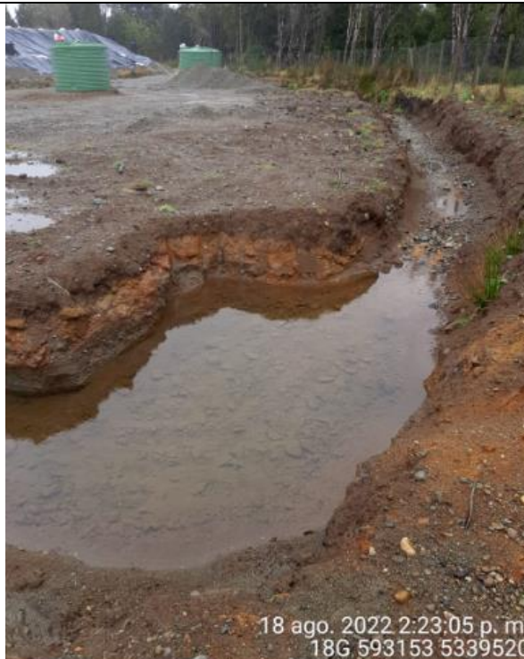
Fotografía N°47: Estado canales aguas lluvias
