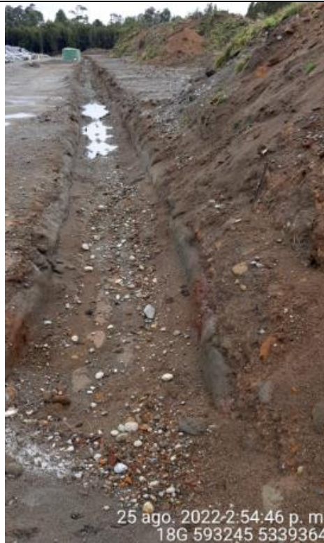
Fotografía N°53: Estado canales aguas lluvias
