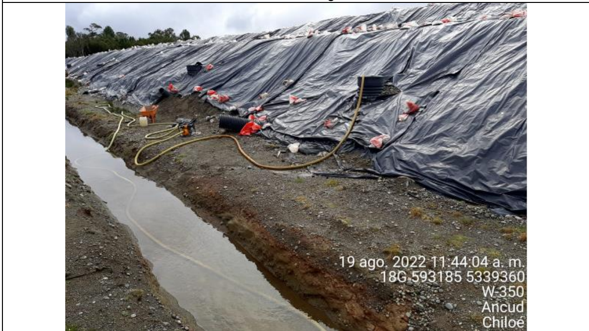
Fotografía N°13: Extracción de Lixiviados desde cámara C02. Tomada: Viernes 19 de Agosto del 2022.
