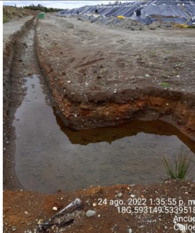
Fotografía N°52: Estado canales aguas lluvias
