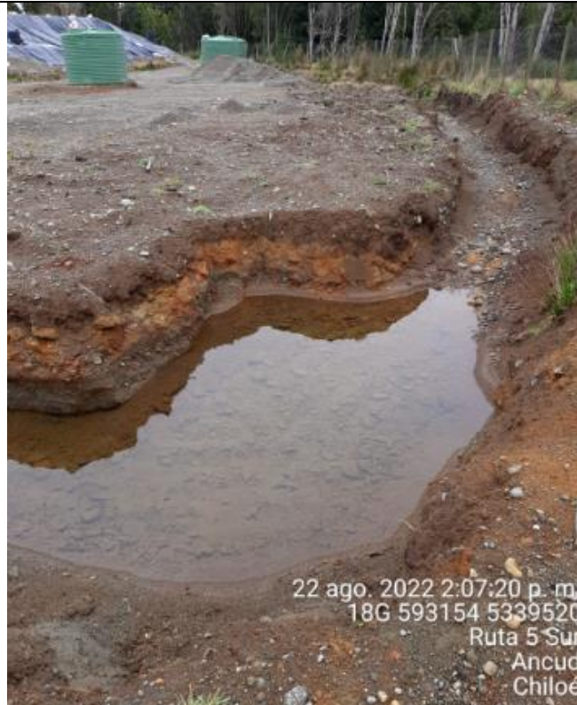
Fotografía N°50: Estado canales aguas lluvias
