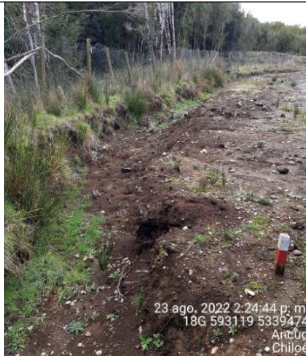
Fotografía N°51: Estado canales aguas lluvias
