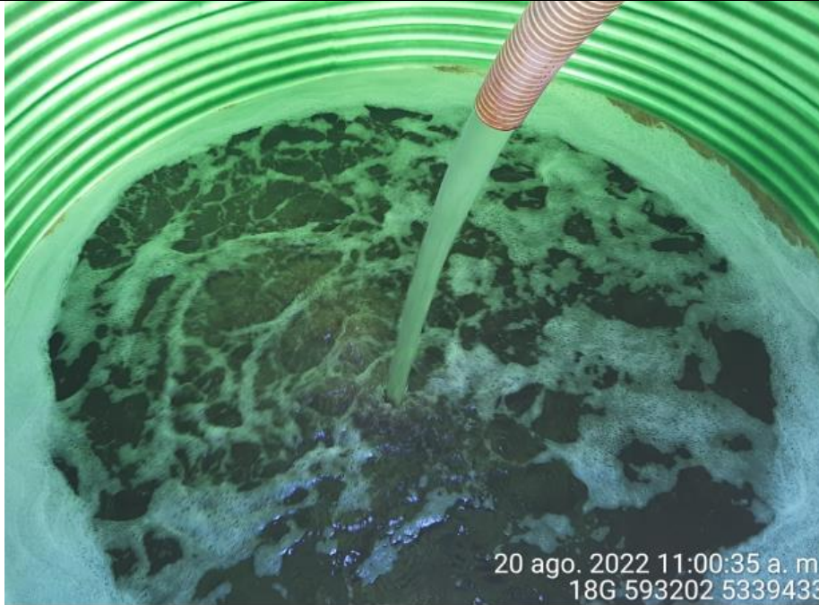
Fotografía N°18: Extracción de Lixiviados a estanque. Tomada: Sábado 20 de Agosto del 2022.
