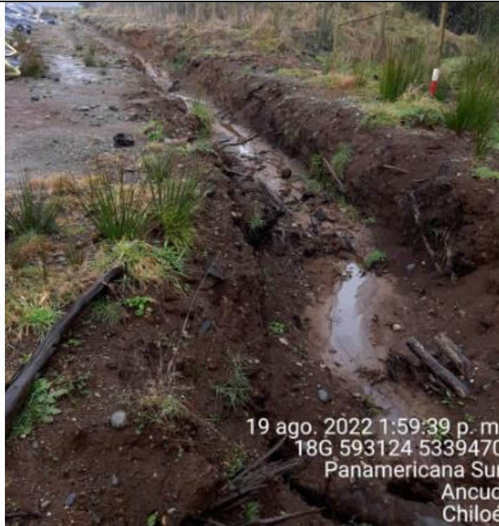
Fotografía N°48: Estado canales aguas lluvias
