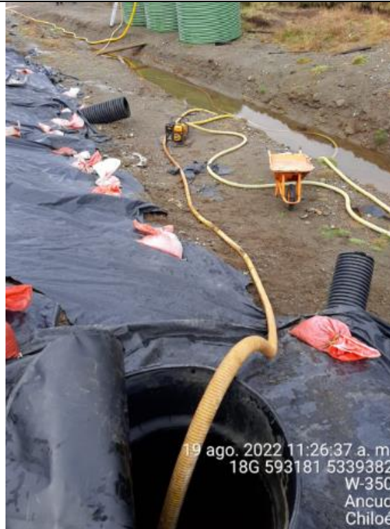
Fotografía N°14: Extracción de Lixiviados desde cámara C03. Tomada: Viernes 19 de Agosto del 2022.
