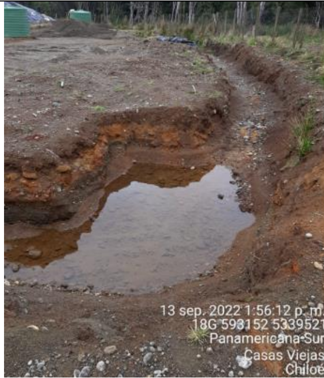
Fotografía N°25: Estado canales aguas lluvias
