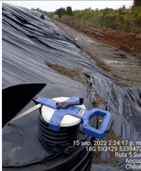
Fotografía N°18: Medición de Niveles de cámaras por Personal Municipal. Tomada: 15 de Septiembre del 2022.
