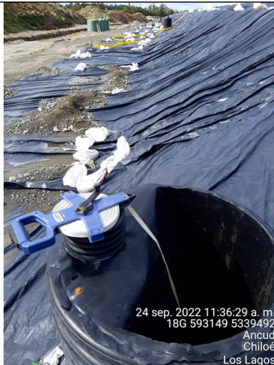
Fotografía N°23: Medición de Niveles de cámaras por Personal Municipal. Tomada: 24 de Septiembre del 2022.
