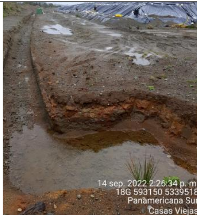
Fotografía N°26: Estado canales aguas lluvias
