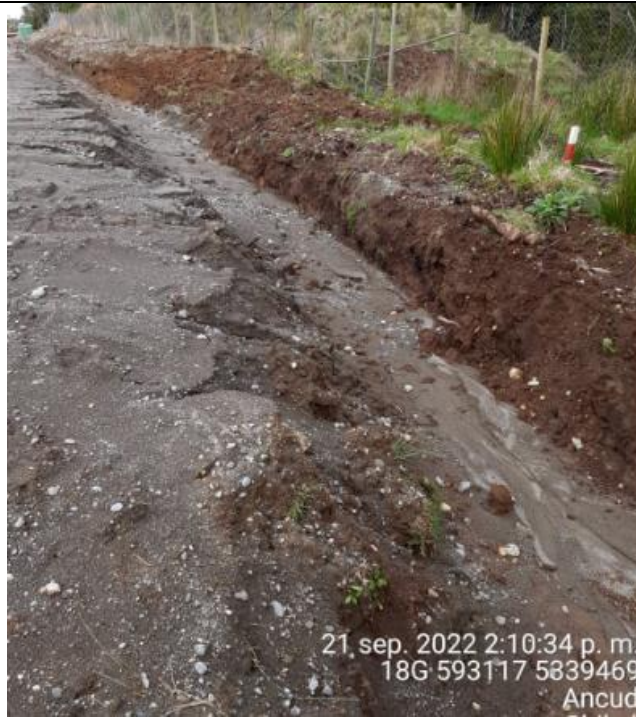
Fotografía N°29: Estado canales aguas lluvias
