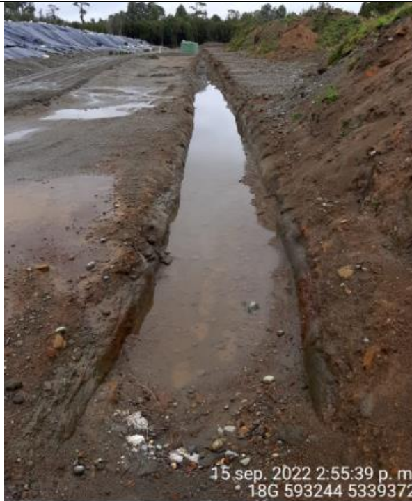
Fotografía N°27: Estado canales aguas lluvias
