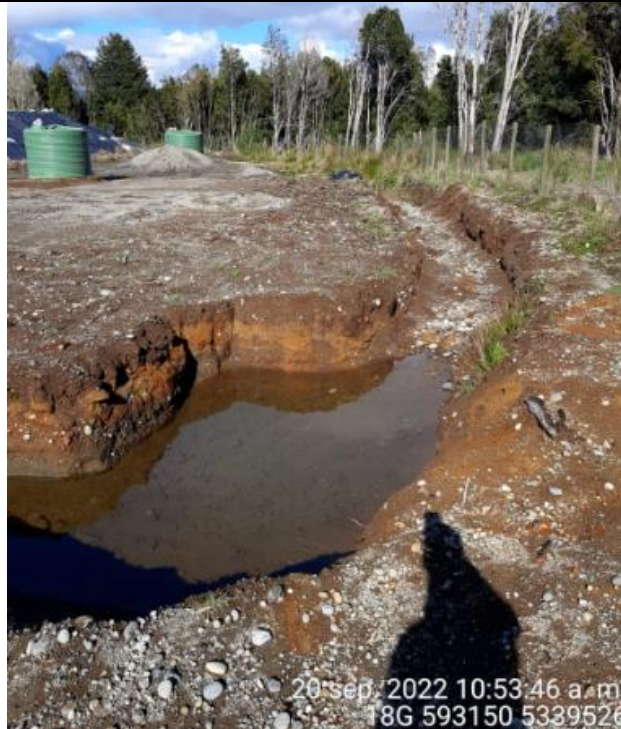
Fotografía N°28: Estado canales aguas lluvias
