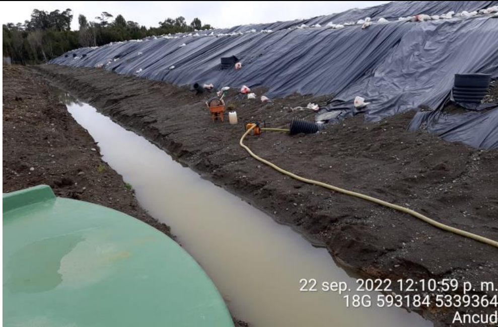
Fotografía N°10: Extracción de Lixiviados desde diagonal D2 Tomada: Jueves 22 de Septiembre del 2022.
