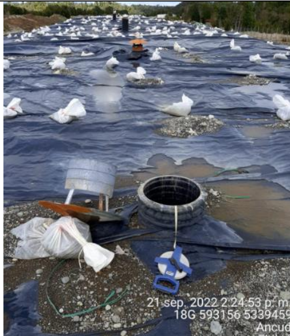
Fotografía N°20: Medición de Niveles de cámaras por Personal Municipal. Tomada: 21 de Septiembre del 2022.
