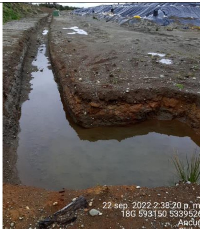
Fotografía N°30: Estado canales aguas lluvias
