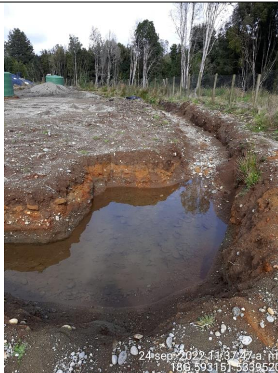
Fotografía N°32: Estado canales aguas lluvias
