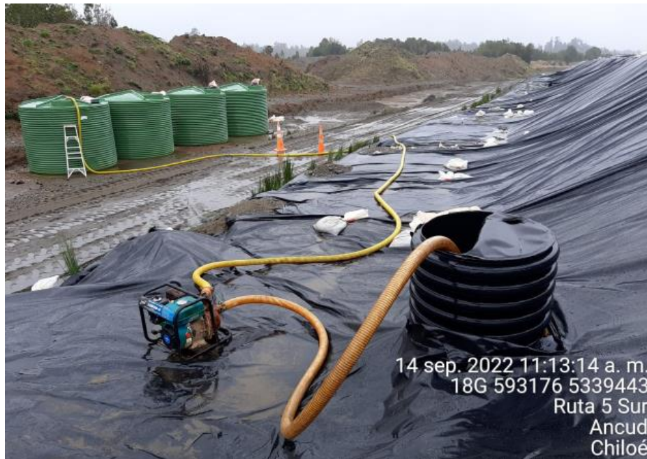
Fotografía N°3: Extracción de Lixiviados desde cámara C12 por personal municipal. Tomada: Miércoles 14 de Septiembre del 2022.
