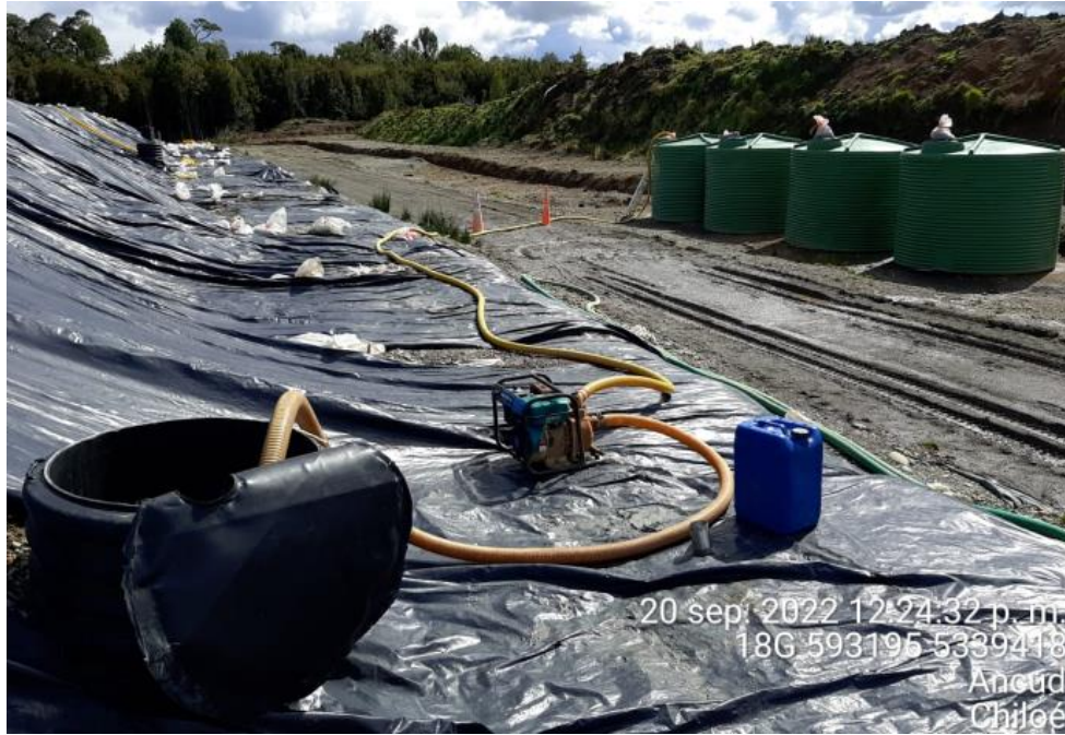
Fotografía N°8: Extracción de Lixiviados desde cámara C13 por personal municipal. Tomada: Martes 20 de Septiembre del 2022.
