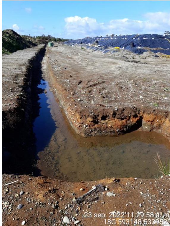
Fotografía N°31: Estado canales aguas lluvias
