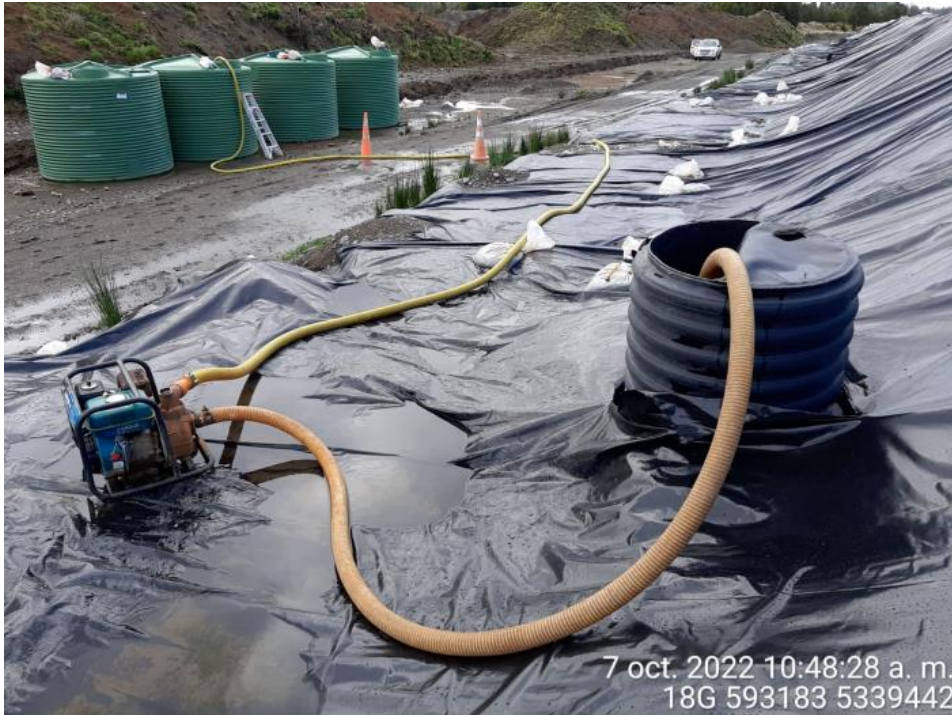
Fotografía N°14: Extracción de Lixiviados desde cámara C12 por personal municipal. Tomada: Viernes 07 de Octubre del 2022.
