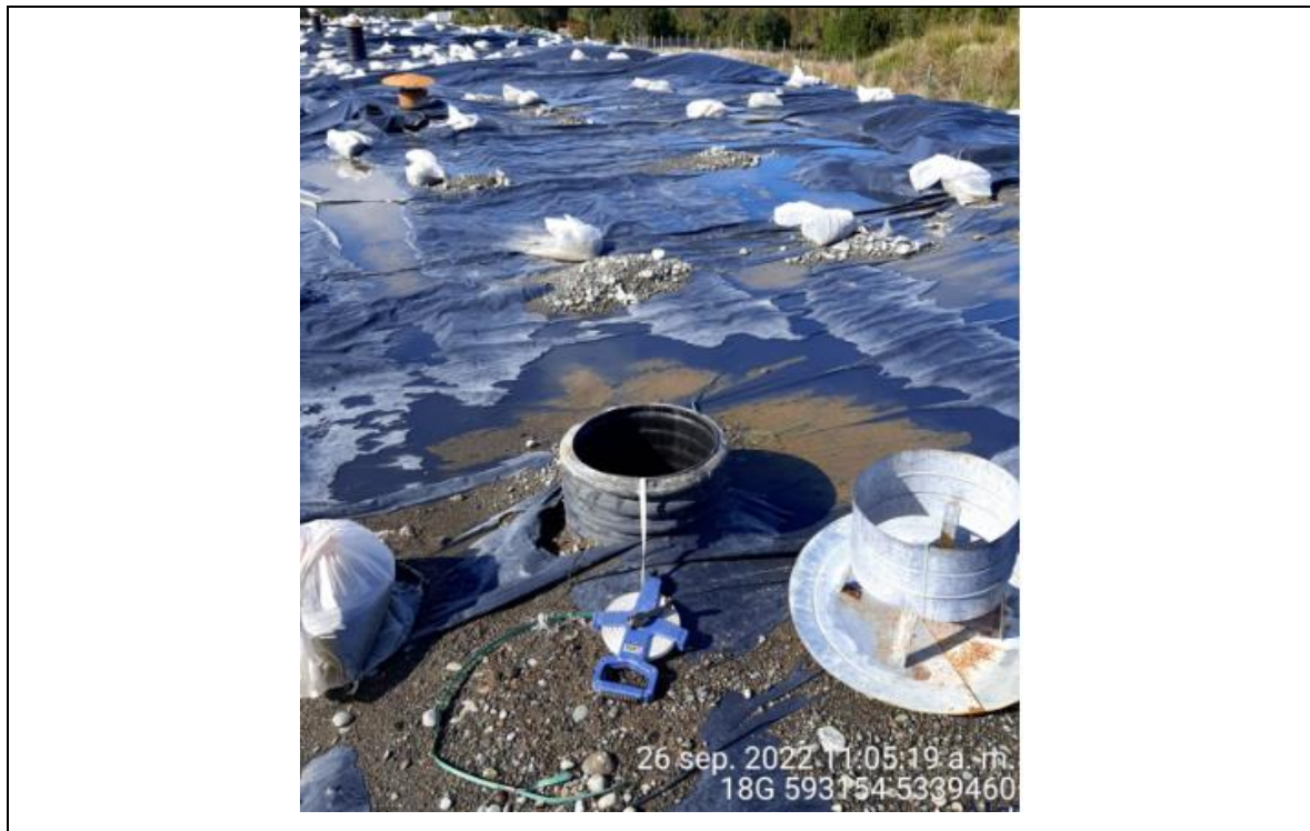
Fotografía N°17: Medición de Niveles de cámaras por Personal Municipal. Tomada: 26 de Septiembre del 2022.
