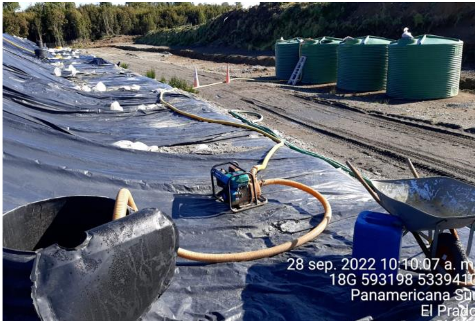
Fotografía N°5: Extracción de Lixiviados desde cámara C13 por personal municipal. Tomada: Miércoles 28 de Septiembre del 2022.
