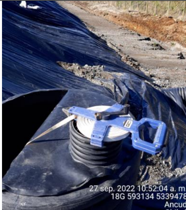
Fotografía N°18: Medición de Niveles de cámaras por Personal Municipal. Tomada: 27 de Septiembre del 2022.
