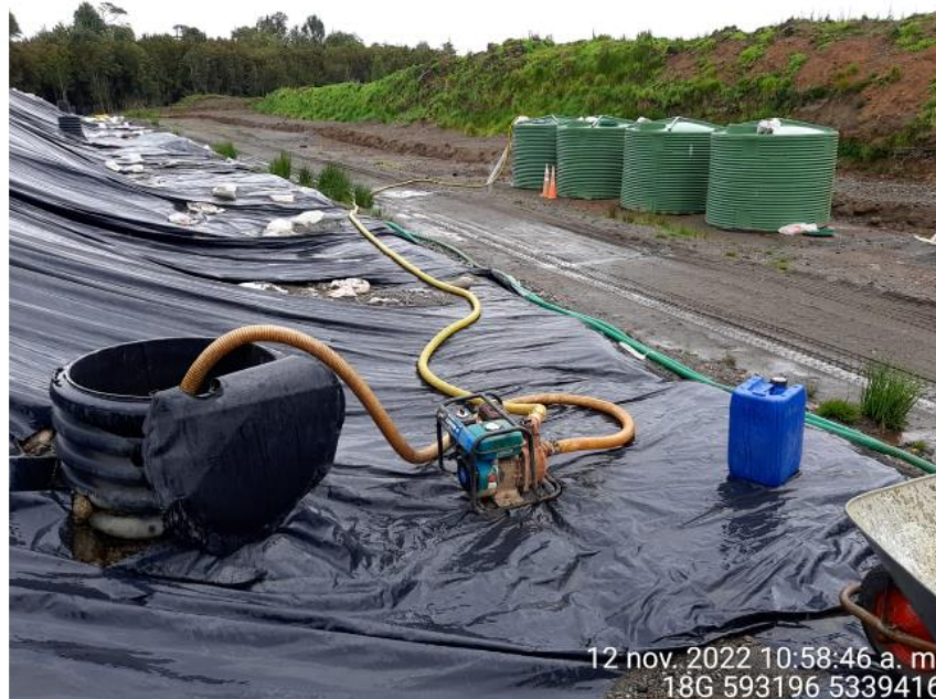
Fotografía N°15: Extracción de Lixiviados desde cámara C13 por personal municipal. Tomada: Sábado 12 de Noviembre del 2022.
