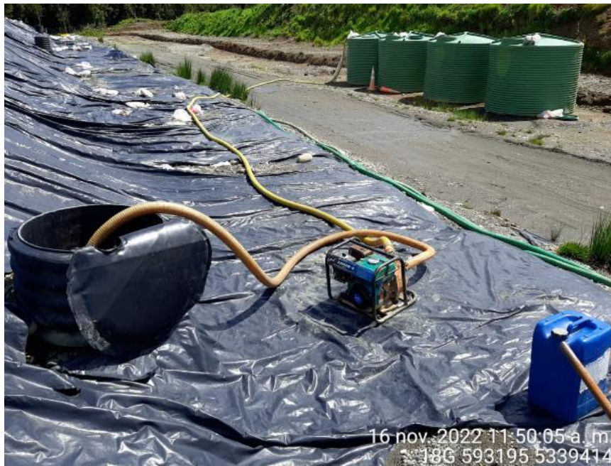
Fotografía N°22: Extracción de Lixiviados desde cámara C13 por personal municipal. Tomada: Miércoles 16 de Noviembre del 2022.
