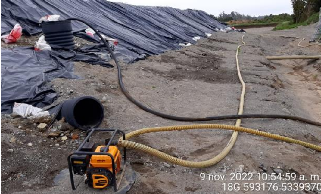
Fotografía N°6: Extracción de Lixiviados desde cámara C02 por personal municipal. Tomada: Miércoles 09 de Noviembre del 2022.
