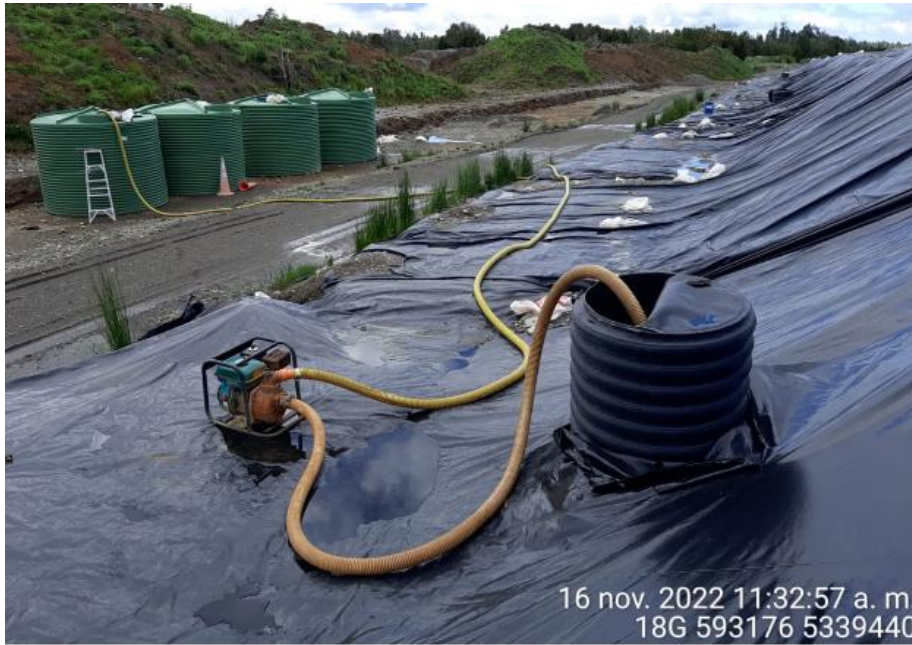
Fotografía N°21: Extracción de Lixiviados desde cámara C12 por personal municipal. Tomada: Miércoles 16 de Noviembre del 2022.
