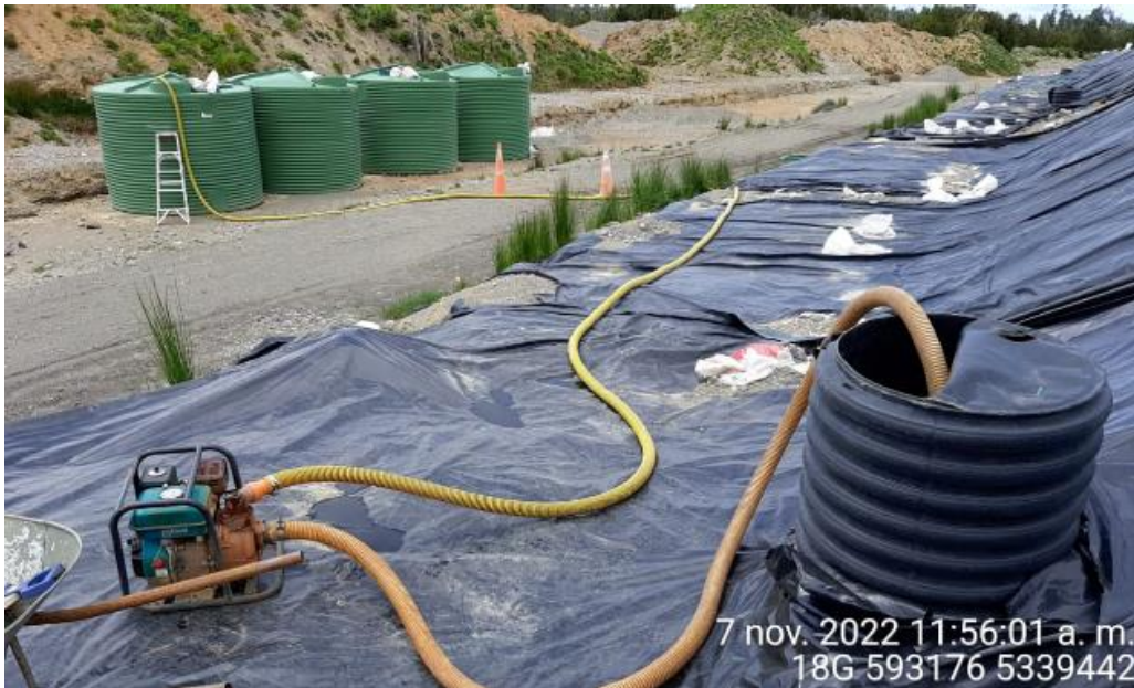
Fotografía N°1: Extracción de Lixiviados desde cámara C12. Tomada: Lunes 07 de Noviembre del 2022.
