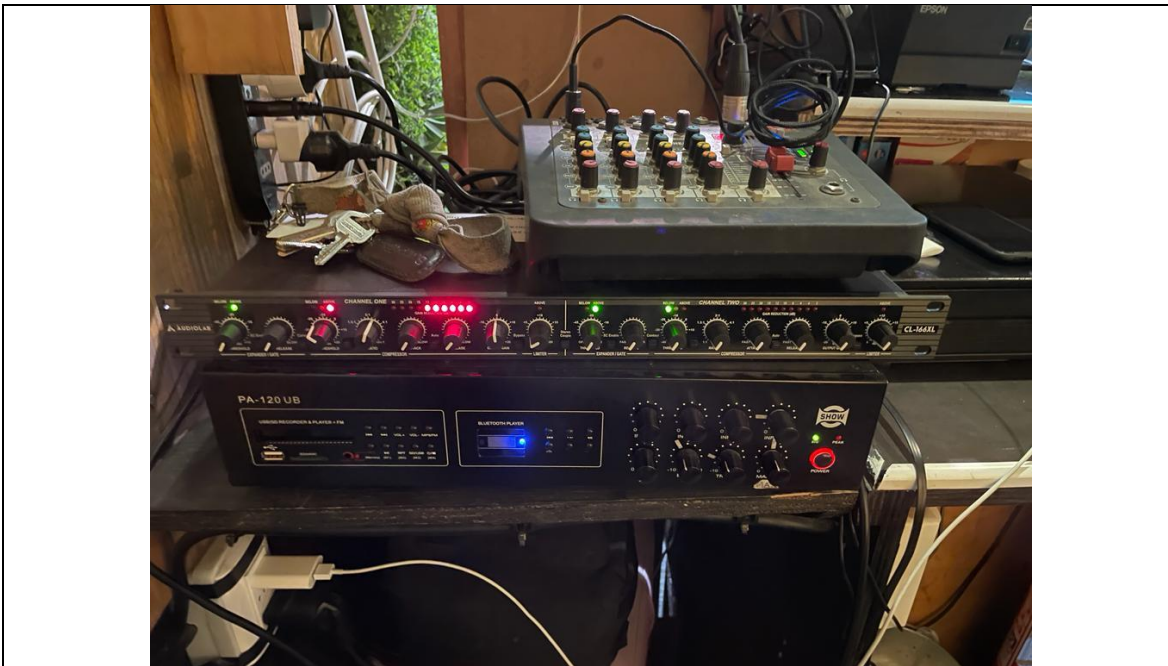
Limitador instalado. Vista frontal
