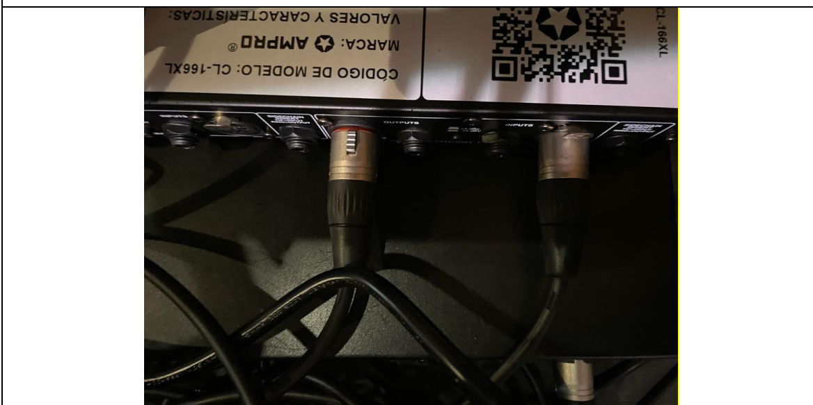
Limitador instalado. Vista trasera
