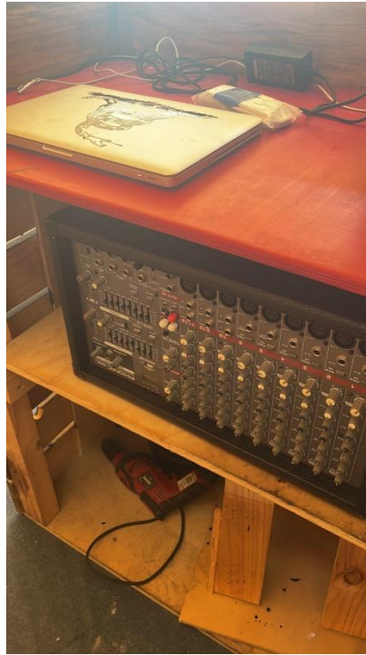
FOTO 3 - Instalación del nuevo equipo power mixer.
