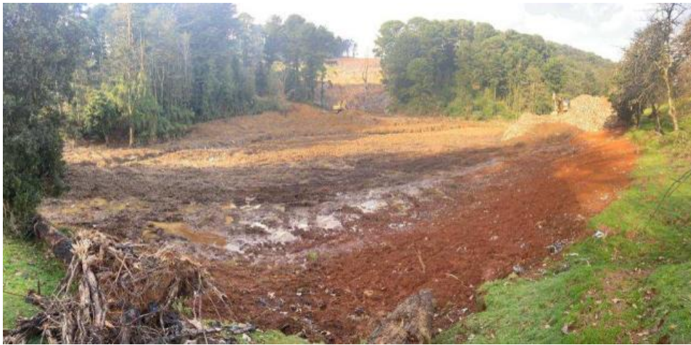
Fig.1 Zona de limpia de residuos, Familia Valencia Mellado, se observa cúmulo final que se está sacando.
