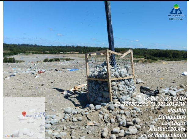
Chimenea conformada para empalme
