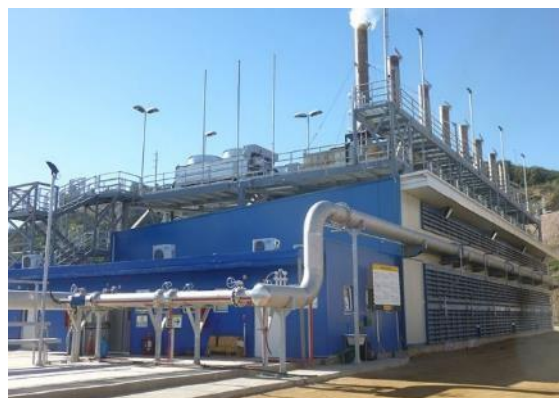
Control de Ruido Central Santa Marta
