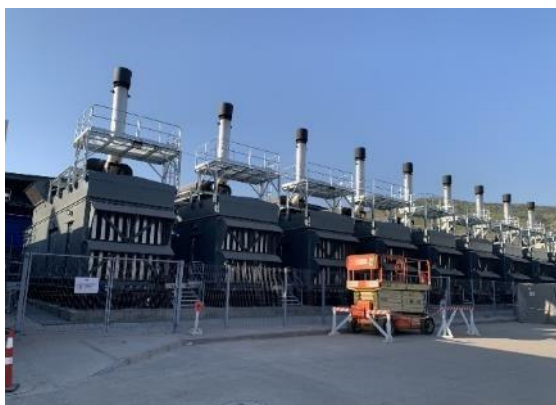
Cabinas Acústicas Data Center Ascenty
