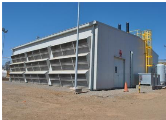
Sala Generación GNL Quintero. 7.5MW
