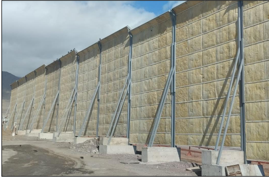
Figura 7. Pantalla acústica sector Sur.
