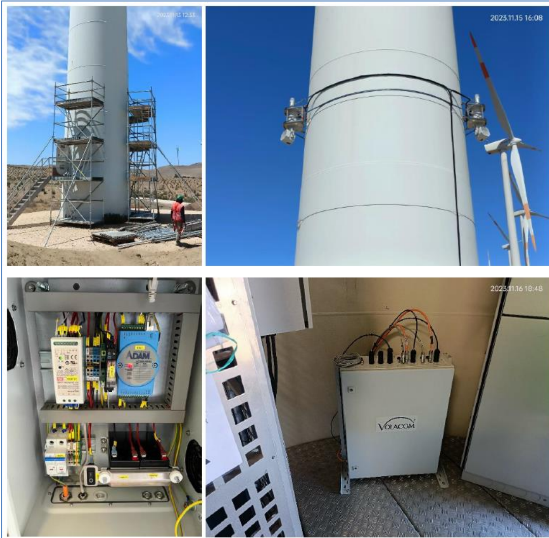
Figura 5. Instalación BCAS en PTO-03.
