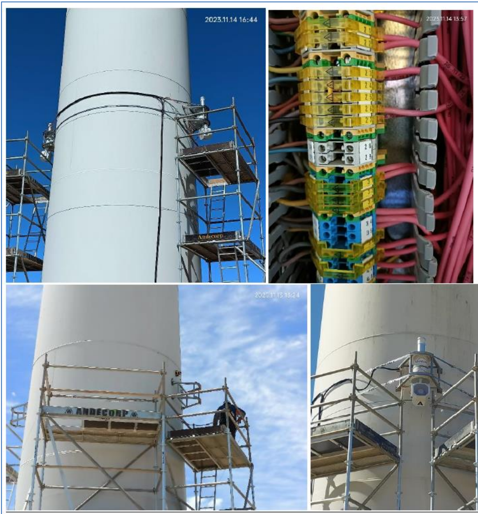
Figura 6. Instalación BCAS en PTO-04.
