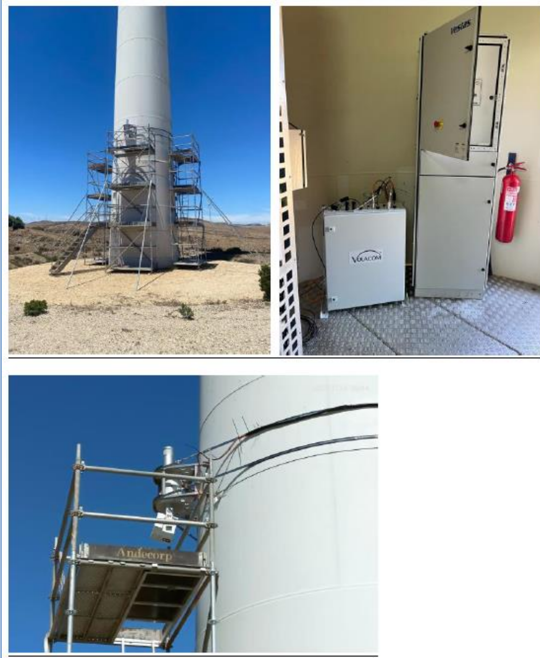
Figura 6. Instalación BCAS en PTO-06.
