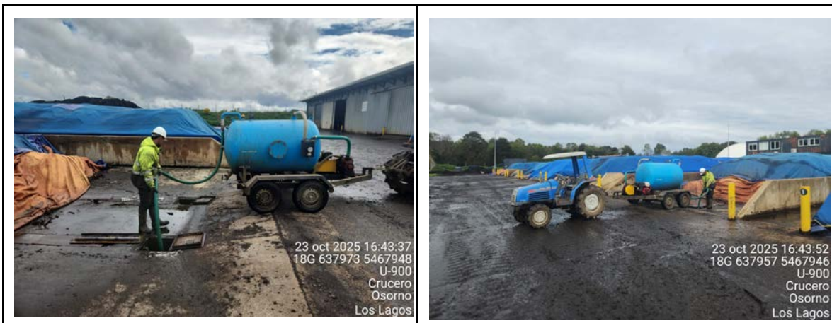
Imagen 2. Fotografía de mantenimiento de cámara de lixiviados (Trampa de lechada) usando el “pichoncito”
