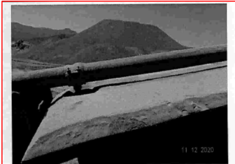
Fotografía 26 Fecha: Fecha: 11-12-2020 Descripción Acumulación de polvo mineral sobre estructuras de la correa CT-108.
