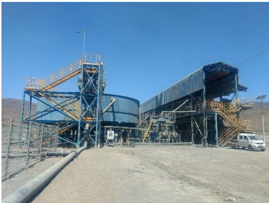
Planta de espesamiento de filtrado
