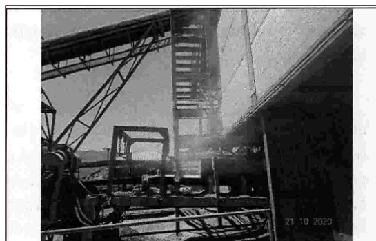
Fotografía 12 Fecha: 21-10-2020 Descripción Emisión de material particulado en el sector del Chancador 3° su harnero y en correa de retorno al chancador 2°.
