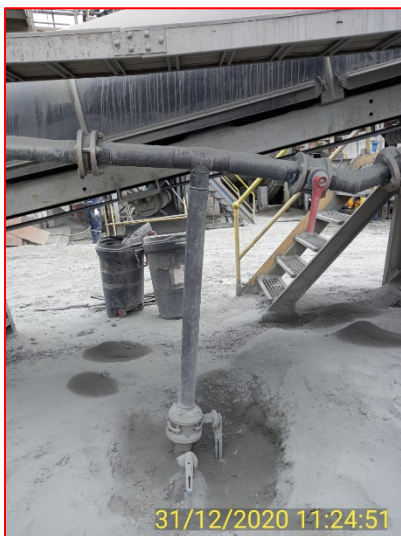
Tubería que alimenta sistemas de humectación en línea de chancado N°2 sin totalizador.
