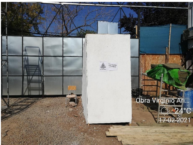
Figura 5. Encierro grupo electrógeno – Fuente: Entregado por el titular.
