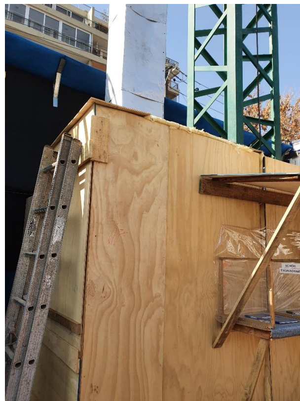
Figura 6. Encierro grúa torre – Fuente: Inspección en terreno.
