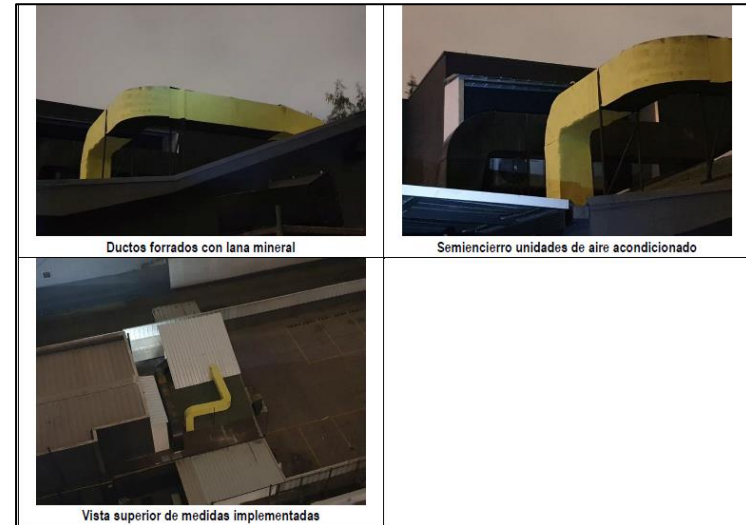
Figura 4. Ductos forrados con lana mineral. Fuente: entregado por el titular.
