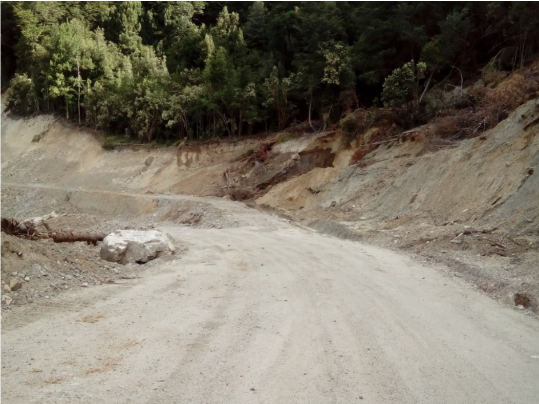
Km 13,6 Coordenadas 19G 255.001 E – 5.384.727 N. Sector en construcción con peligro de Derrumbe
