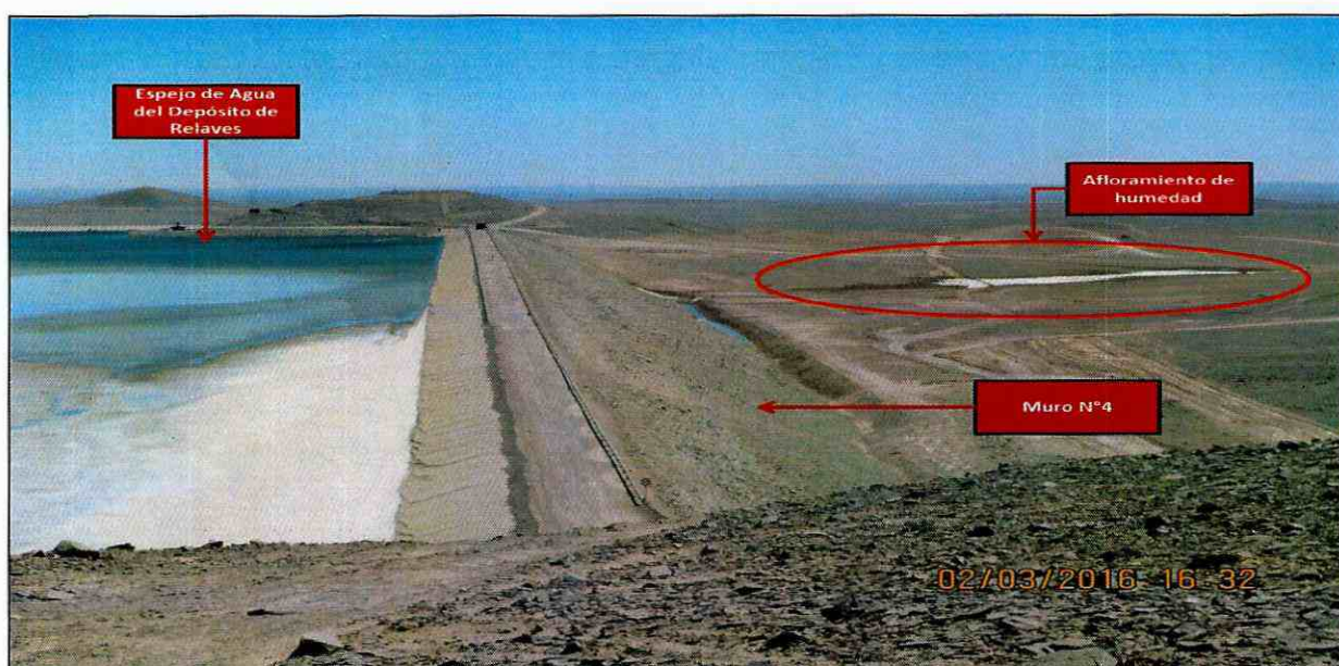
Figura 6. Fotografía de fecha 02 de marzo de 2016, aguas abajo del muro N°4 del Depósito de Relaves, en la que se observa afloramiento de humedad (costras salinas) y espejo de agua del depósito de relaves de relaves.
