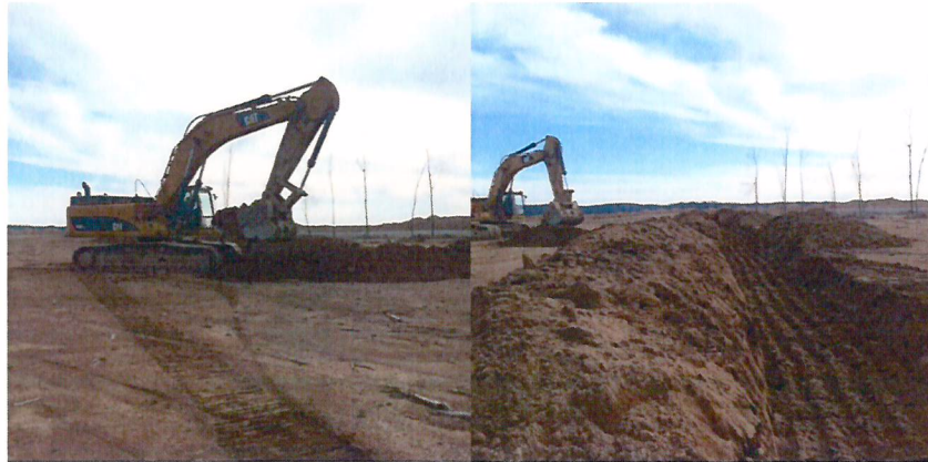
Figura N° 1. Canalizaciones provisorias en sector superior del Botadero
