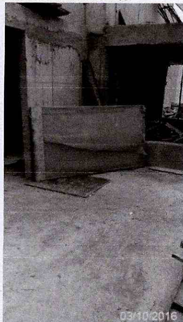
Pantalla acústica móvil simple en cubierta
