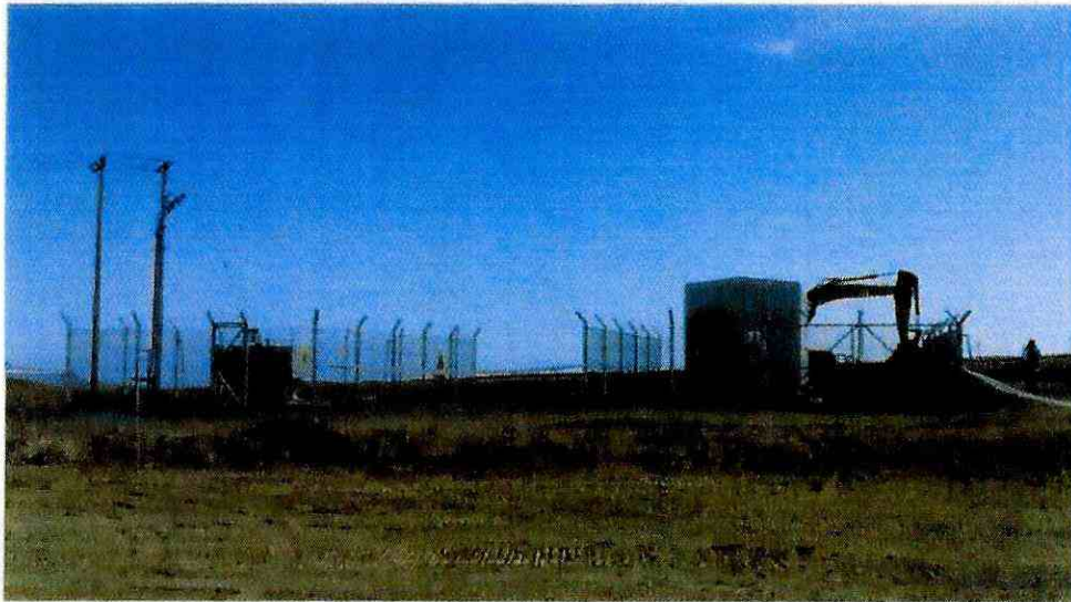
Figura N°10: Estación y Sala Eléctrica Principal.
