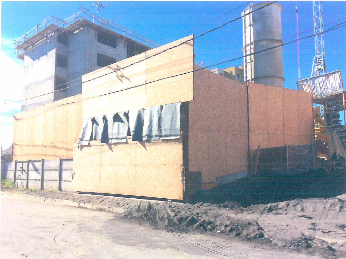
Fotografía 1: Implementación de encierros acústicos para planta fija de hormigón.
