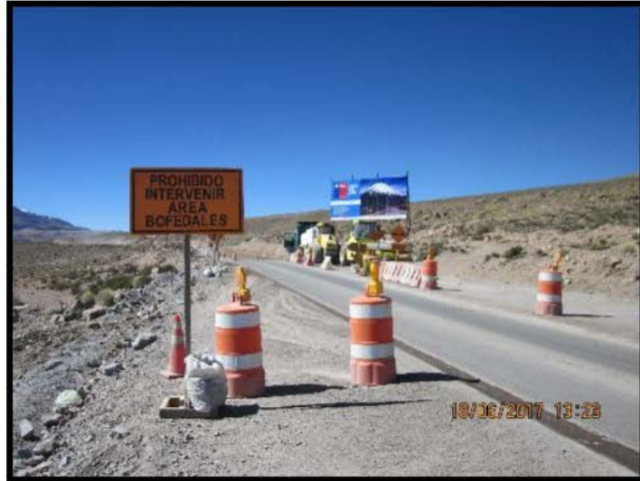
Señalética preventiva, km 170,000 (Inicio obra).
