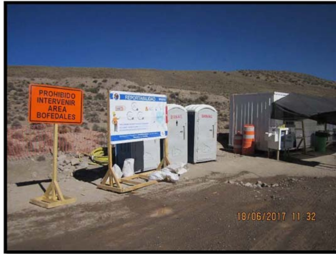
Señalética preventiva, km 182,500 (Sector refugio).
