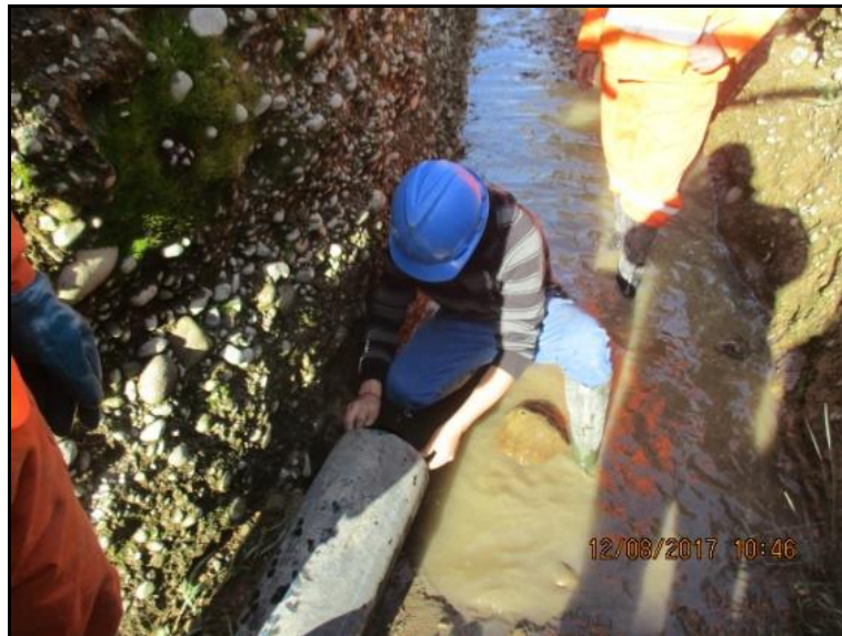
Imagen 2.6. Instalación tapón de HDPE y sellado con cordón extrusor de soldadura de HDPE de 1.5 mm. (Vista 1)
