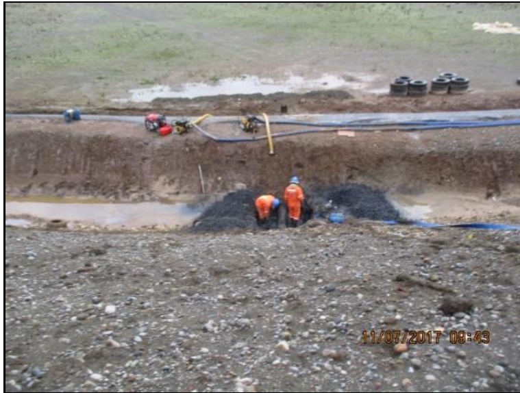
Imagen 2.1. Retiro de material, hasta llegar a la tubería preparando el terreno para la instalación de la guillotina. (Vista 1)
