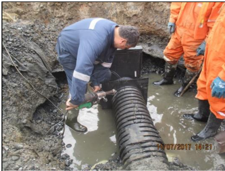
Imagen 2.4. Instalación y sellado de la guillotina a la tubería existente de conducción de lixiviados. (Vista 4)
