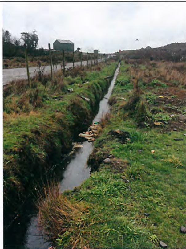
Fotografía N°6: Canal de aguas lluvias sector noroeste, en este sector es posible observar residuos plásticos y lixiviados color gris zaceo y oleosa.
