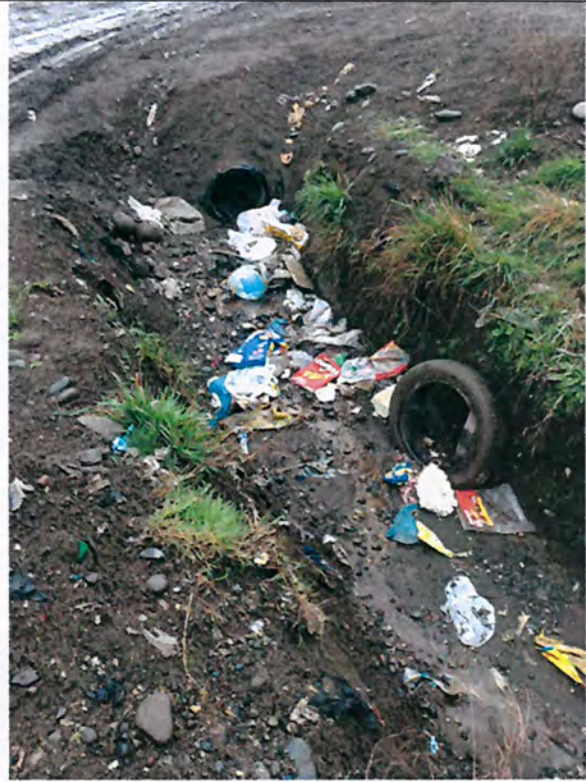
Fotografía N°5: Canal de aguas lluvias con residuos principalmente plásticos (Sector Noroeste), se observa tubería HDP corrugada.
