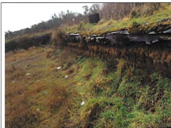
Fotografía N°16: : Lugar donde estuvo la estructura de la piscina de lixivados del sector Oeste, se observa restos de geomenbrana de la piscina y cámara de monitoreo.
