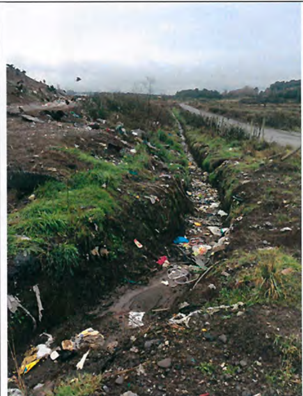
Fotografía N°7: Canal de aguas lluvias sector Noroeste con residuos
