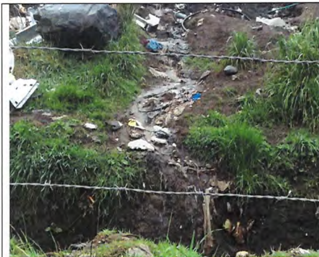
Fotografía N°14: Esguerrimiento de aguas lluvias con lixivados en el sector Noroeste del vertedero, el cual llega al canal de aguas lluvias el cual posteriormente evacua en el sector de extracción de áridos.
