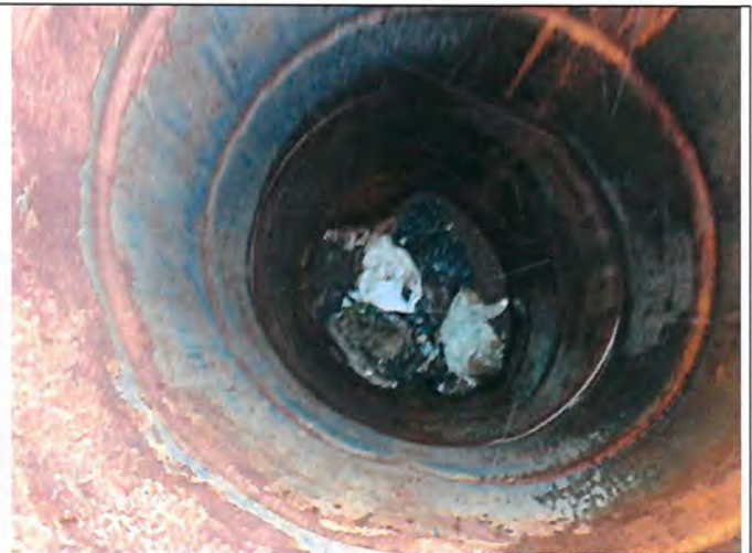
Fotografía N°21: Interior de chimenea con residuos plásticos en su interior.
